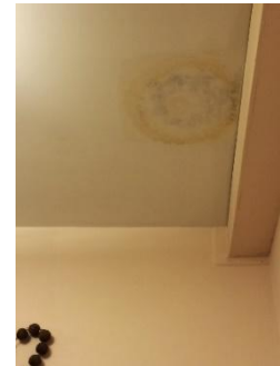
Imagen No. 27. Mancha de agua en el tumbado de la habitación.
