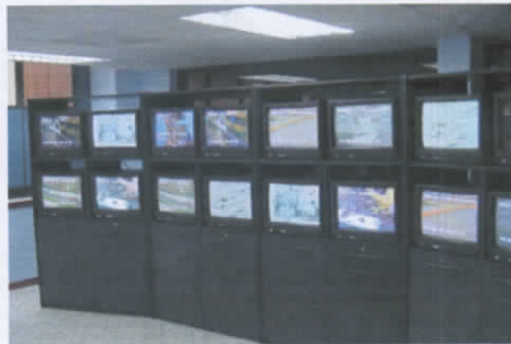
Figura 2.40: Cuarto de Control
