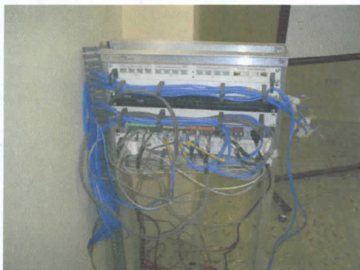
Armario de Telecomunicaciones (Aula 4)
