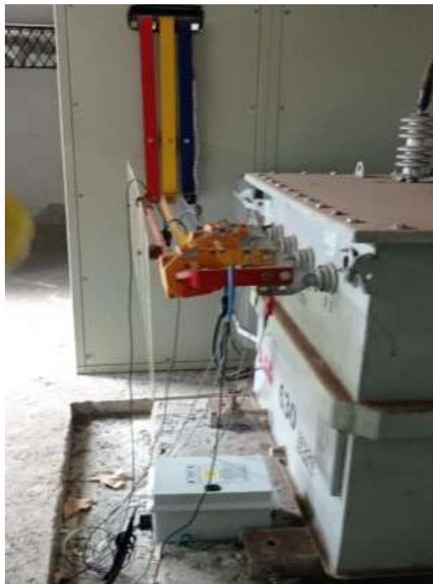
Figura 7 Toma de carga en transformadores. Fuente: Elaboración propia.
