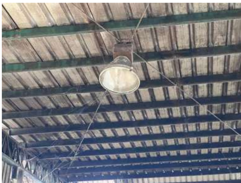
Figura 13 Luminarias instalada actualmente. Fuente: Elaboración propia.
