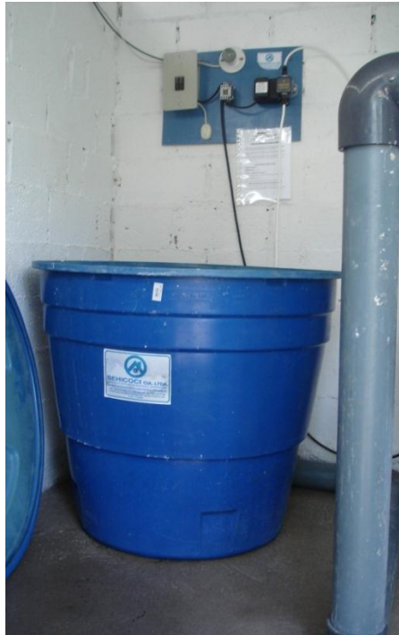
Imagen 1 – Tanque para cloración
