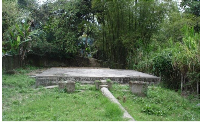
Imagen 4 – Tubería de entrada a tanques sépticos
