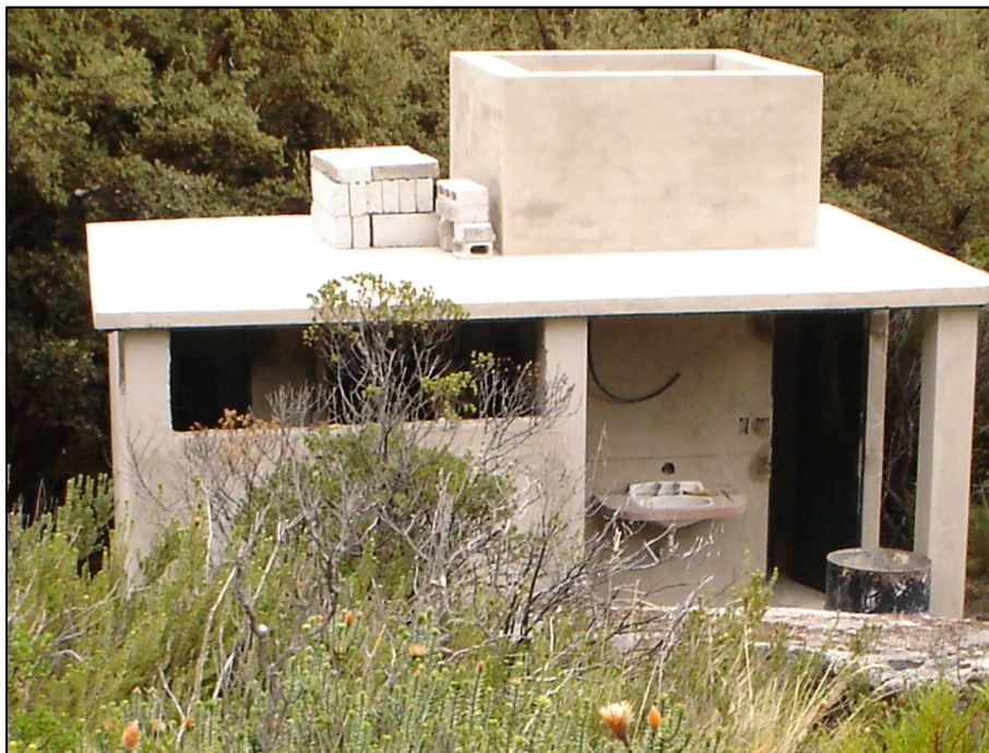
Fotografía 11: Módulo de baterías sanitarias. Fuente: agi, 2009.
