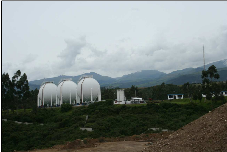
Fotografía 4: PETROPRODUCCIÓN, bombonas de gas presurizado. Fuente: agi (2009)
