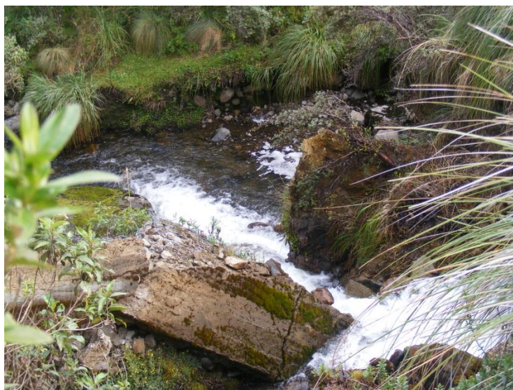
Foto No. 9 Puente Roto
