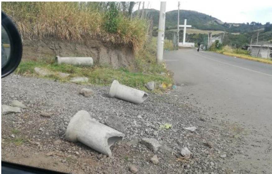
Fotografía 5 Restos de tuberías del alcantarillado
