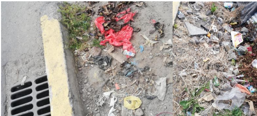
Fotografía 18 Basura acumulado cerca de la alcantarilla
