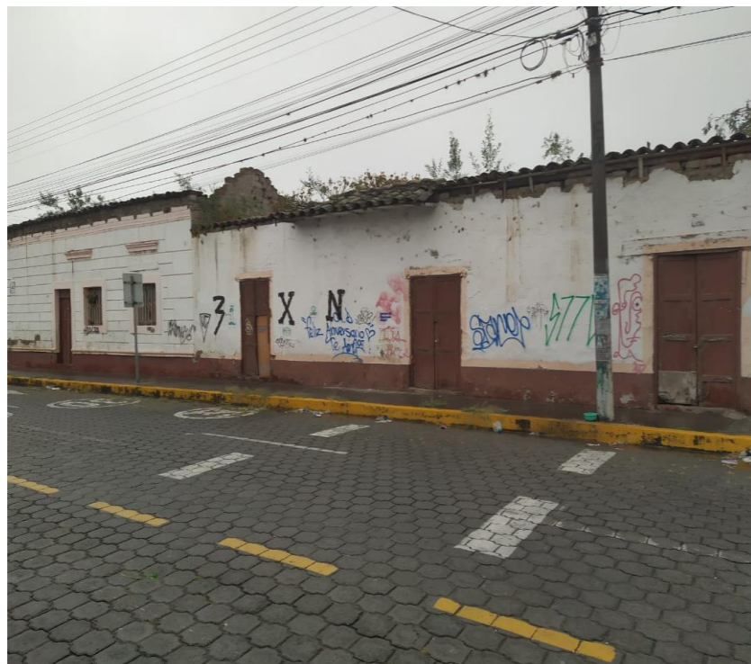
Figura 4. Espacios abandonados y deteriorados Fuente: Elaboración propia
