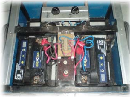
Ilustración 12: Motores, baterías, reóstatos terminales de conexión y carga ensamblados en la base inferior
