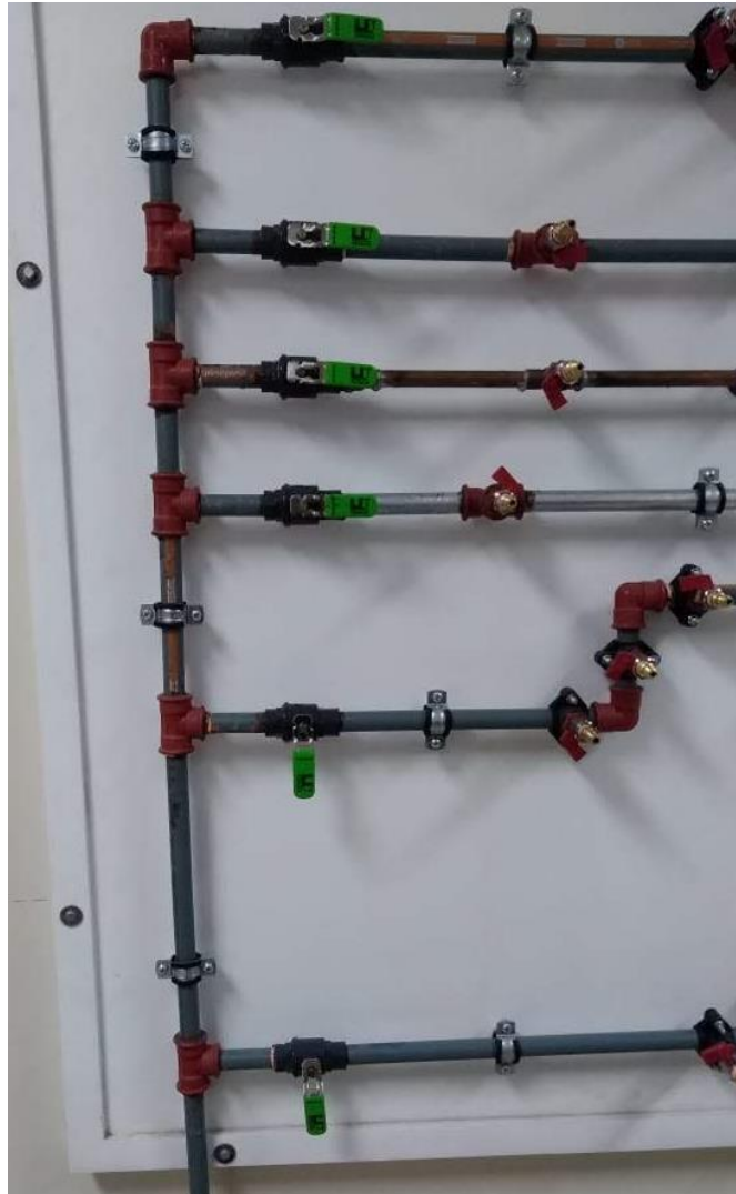
Fotografía 33: Válvulas de Trayectorias
