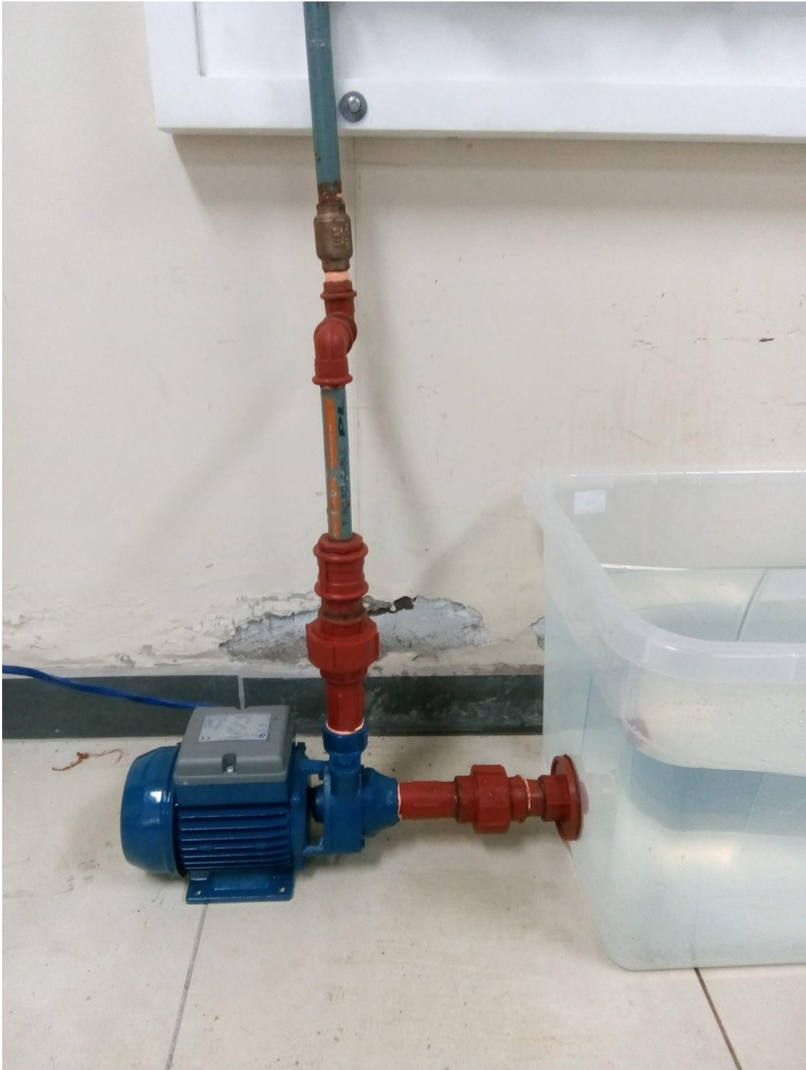
Fotografía 22: Bomba y Tanques de Almacenamiento
