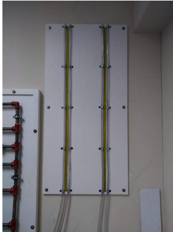
Fotografía 51: Piezómetros de Columna de Agua
