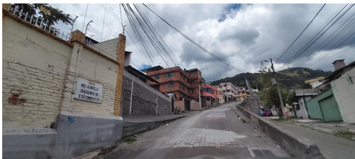
Figura 47 Fotografía Estado de una acera que requiere intervención – calle Caranqui y Cayapas
