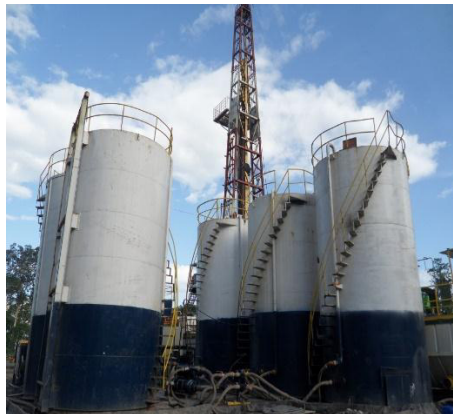
Figura 7: Tanque vertical para almacenamiento de agua
