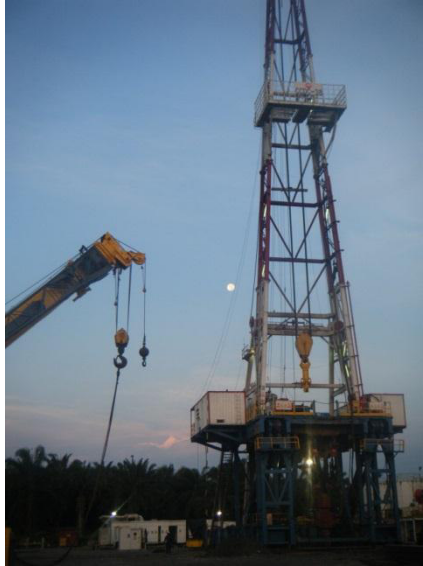
Figura 2: Fotografía de torre de perforación
