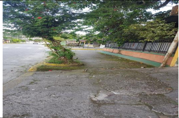
Pavimento agrietado por el agua
