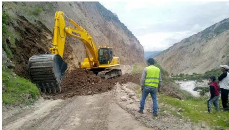
Ilustración 1 Uso de excavadora en campo sin normas de seguridad (Autoría Propia)
