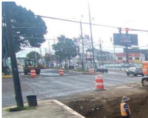
Ilustración 20 Tanquetas instaladas en intersección de vías (Autoría Propia)
