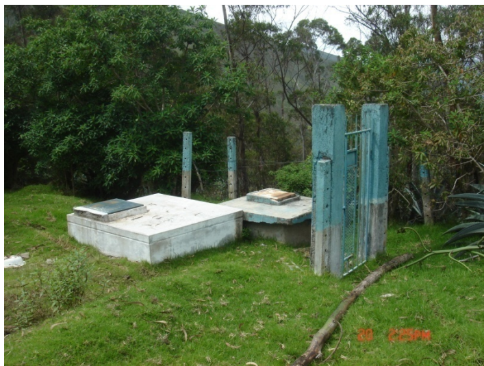
Fotografía 27. Tanque rompe presión – Sector Chaupi Guarangui (2527 m.)
