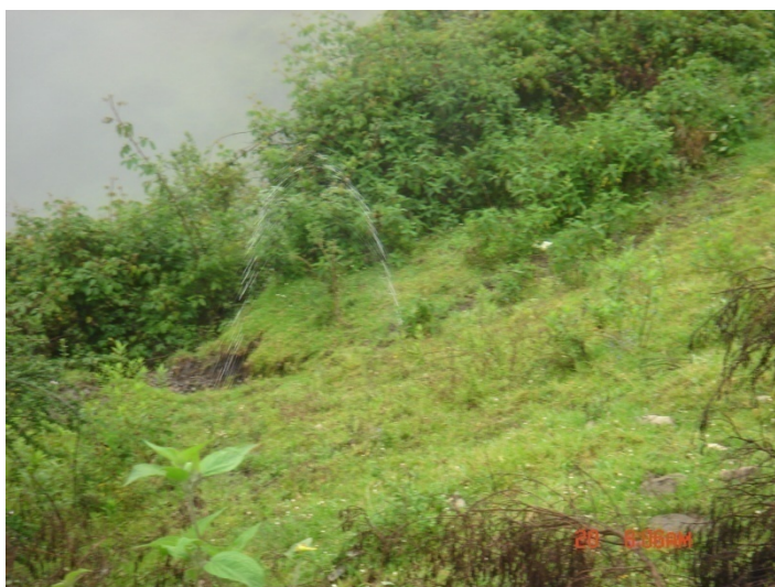
Fotografía 26. Válvula rompe presión de aire – Sector Apangora
