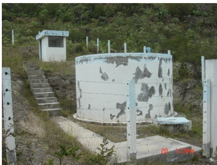
Fotografía 29. Tanque de reserva San Clemente – No funciona
