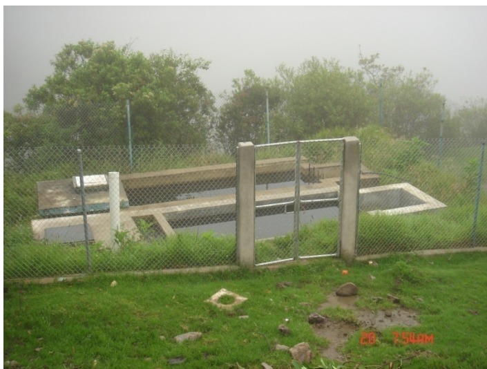
Fotografía 22. Infraestructura del tanque de recepción – Rancho Chico
