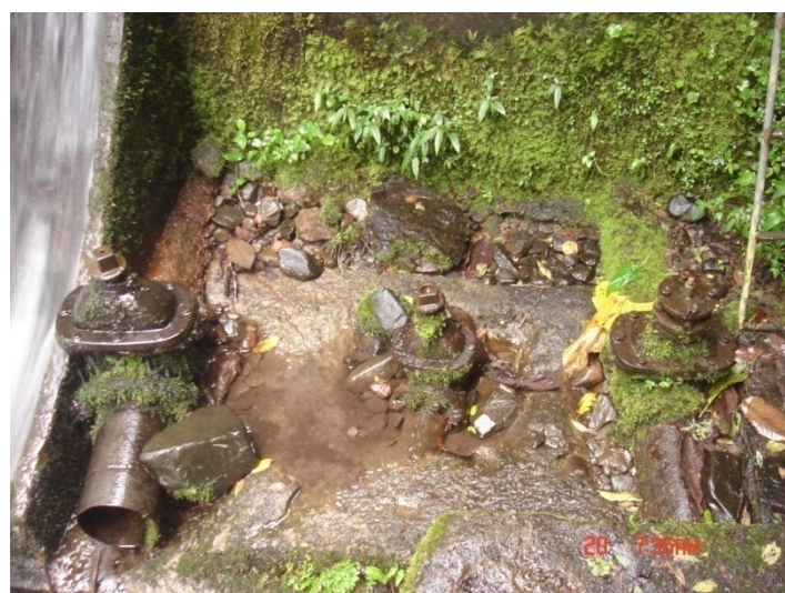
Fotografía 20. Captación – llaves de paso del agua
