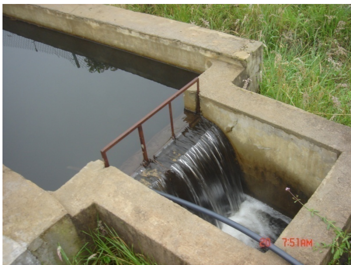
Fotografía 23. El agua se encuentra turbia por presencia de sedimentos
