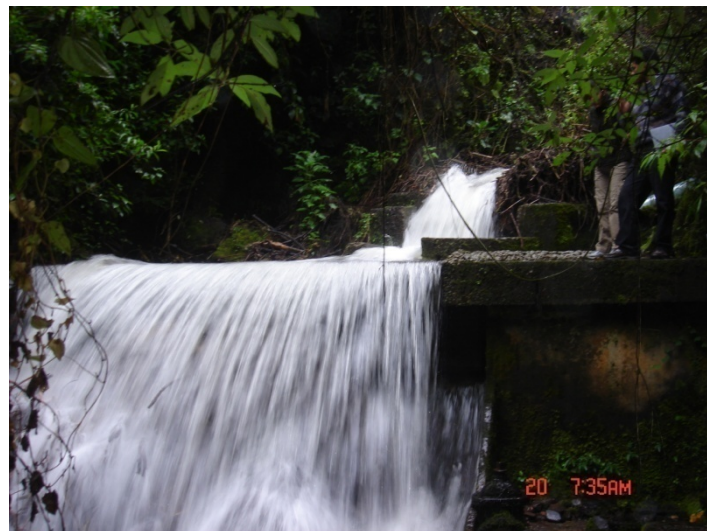
Fotografía 19. Captación de agua - Q. La Chorrera
