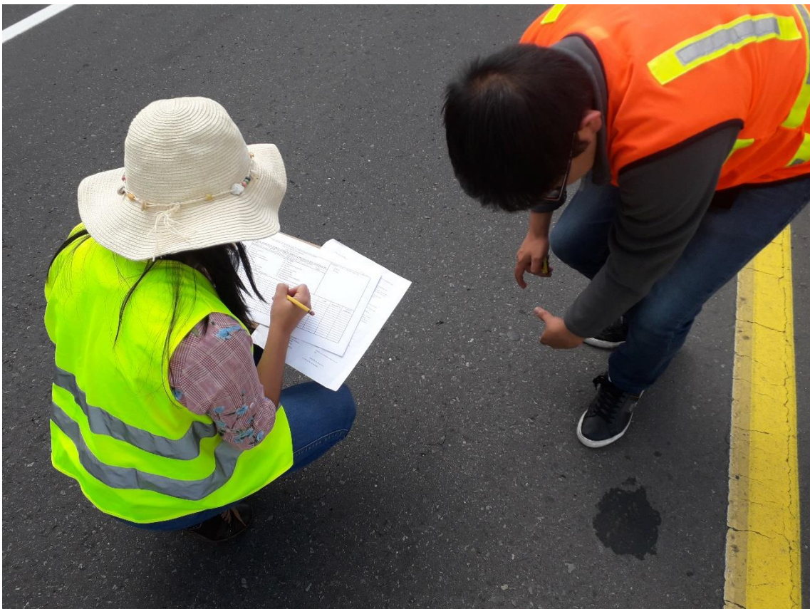
Figura 6-962 Evidencia Fotográfica 2 PCI Autopista General Rumiñahui
