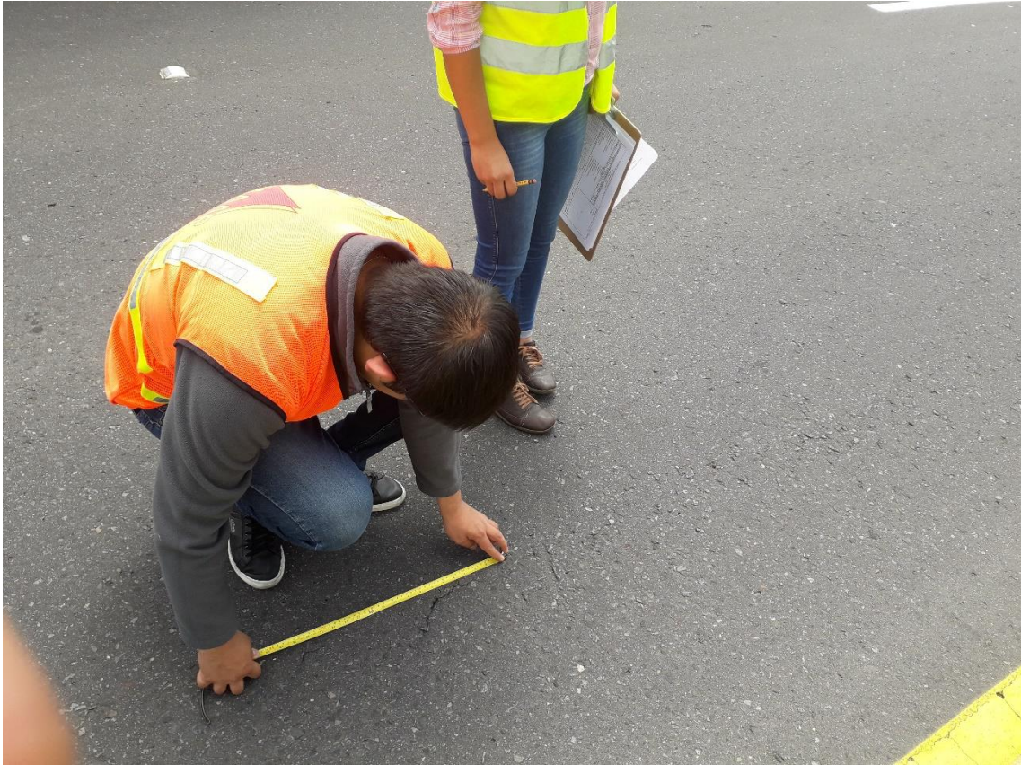
Figura 6-965 Evidencia Fotográfica 5 PCI Autopista General Rumiñahui
