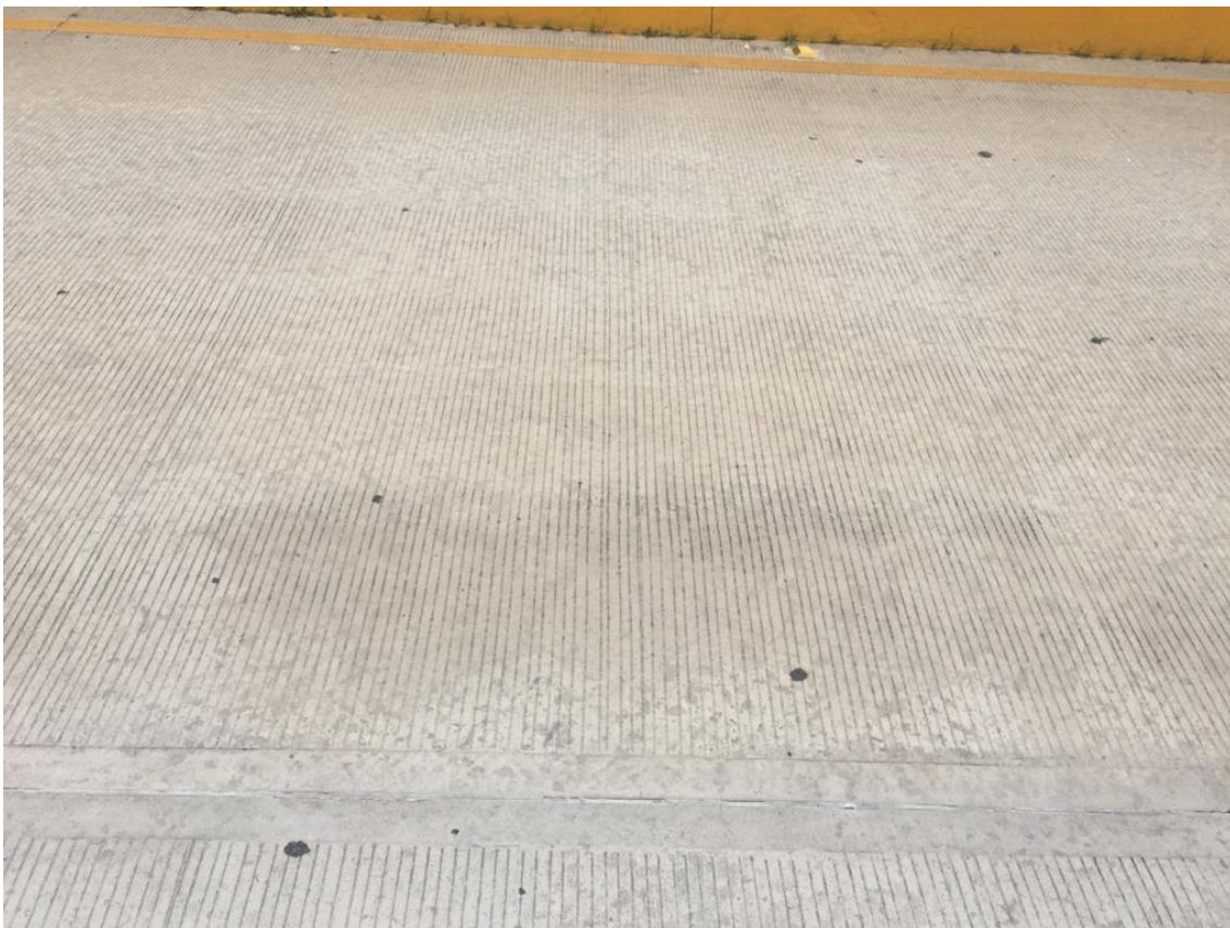
Figura 6-1021 Evidencia Fotográfica 12 PCI Armenia I
