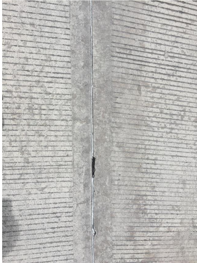
Figura 6-1008 Evidencia Fotográfica PCI Armenia I
