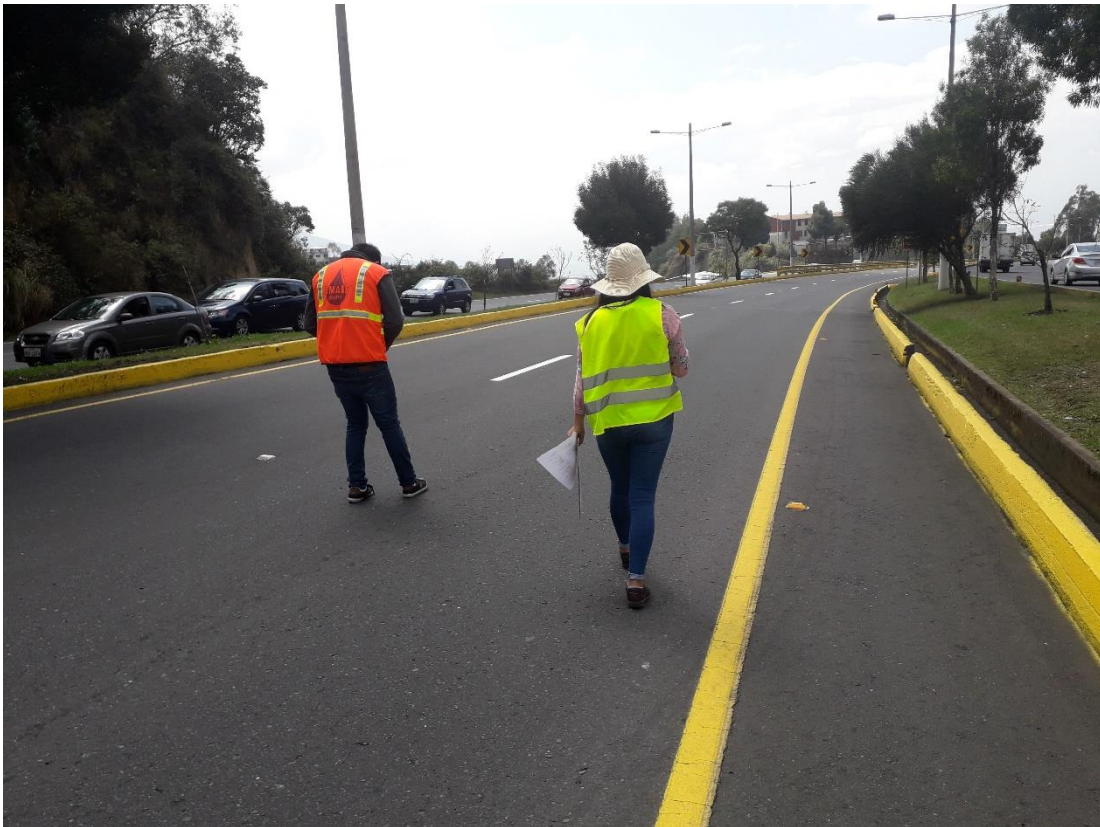
Figura 6-964 Evidencia Fotográfica 4 PCI Autopista General Rumiñahui
