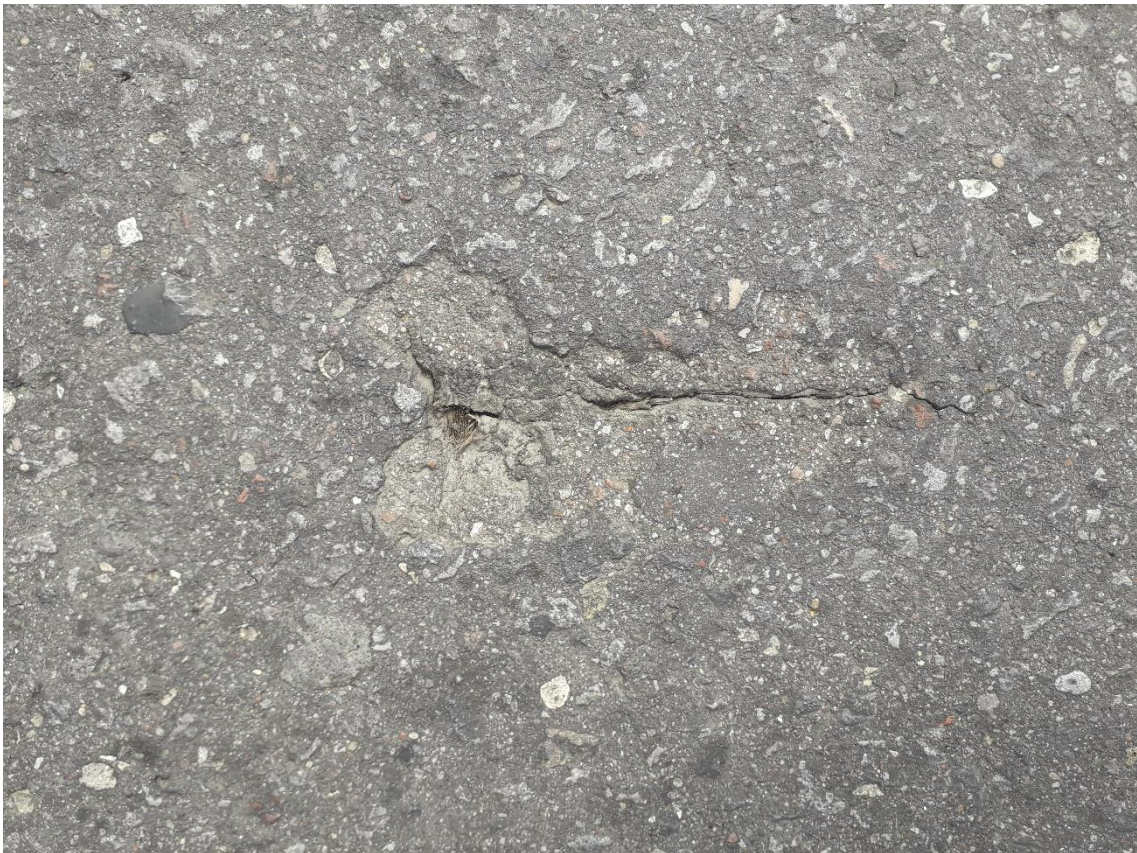
Figura 6-966 Evidencia Fotográfica 6 PCI Autopista General Rumiñahui
