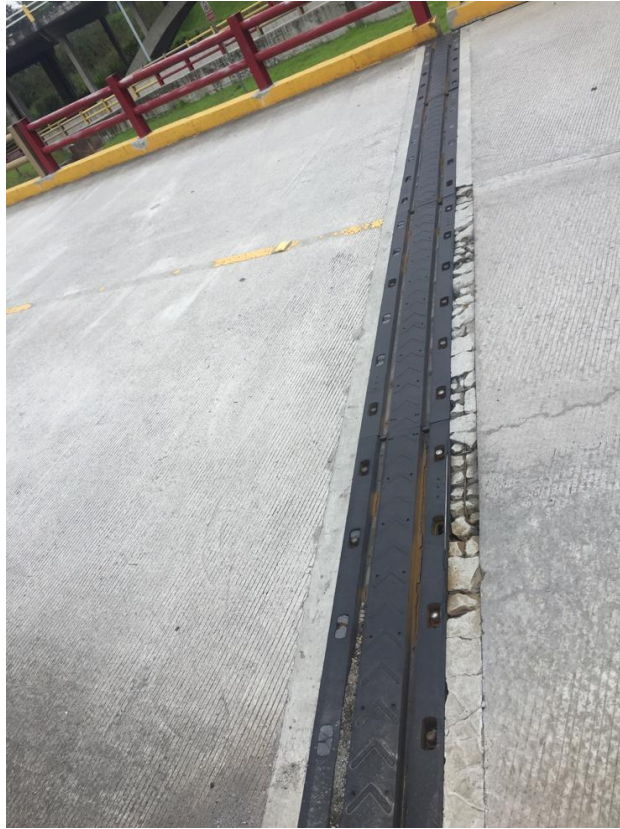
Figura 6-1018 Evidencia Fotográfica 9 PCI Armenia I
