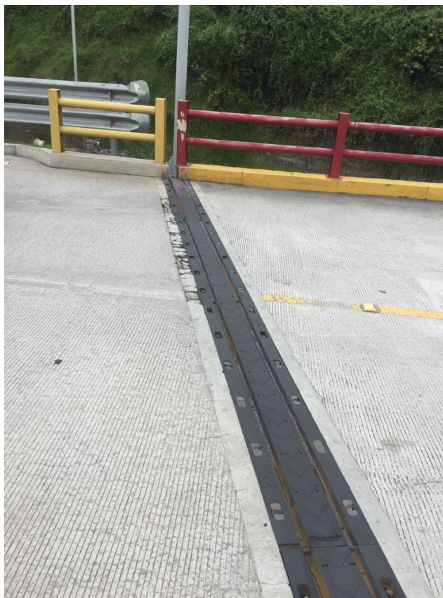
Figura 6-1019 Evidencia Fotográfica 10 PCI Armenia I
