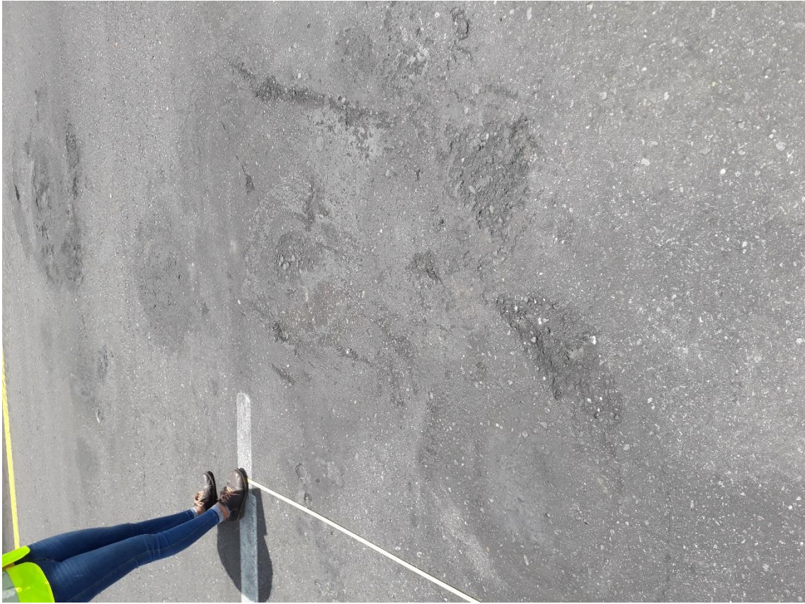
Figura 6-969 Evidencia Fotográfica 9 PCI Autopista General Rumiñahui
