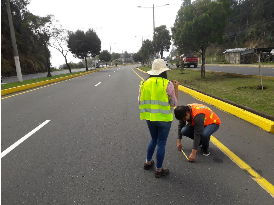
Figura 6-961 Evidencia Fotográfica 1 PCI Autopista General Rumiñahui
