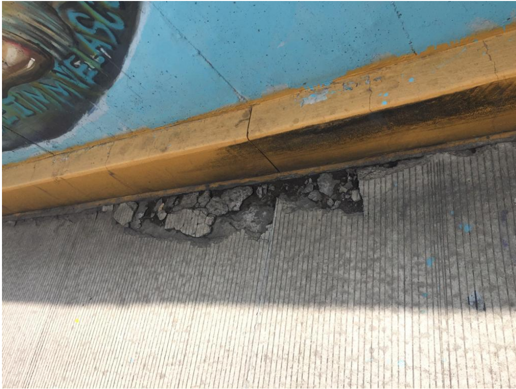
Figura 6-1016 Evidencia Fotográfica 7 PCI Armenia I
