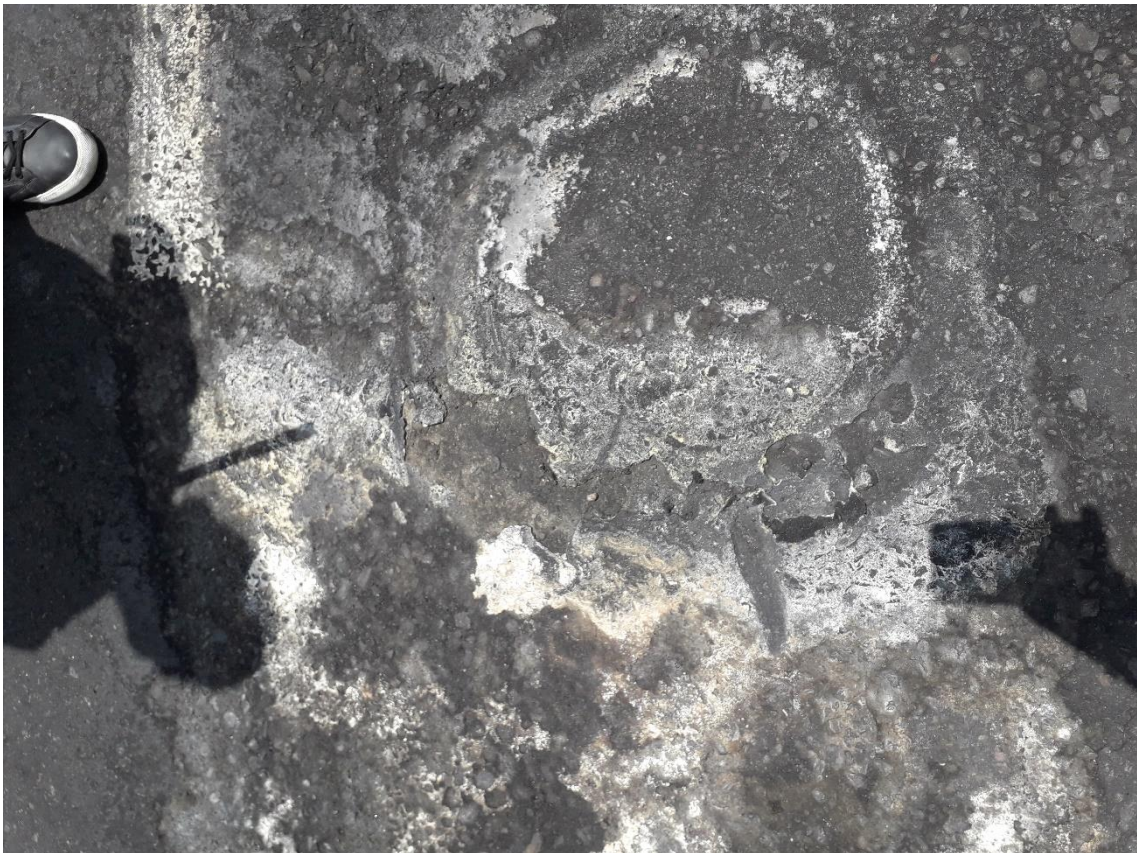
Figura 6-968 Evidencia Fotográfica 8 PCI Autopista General Rumiñahui
