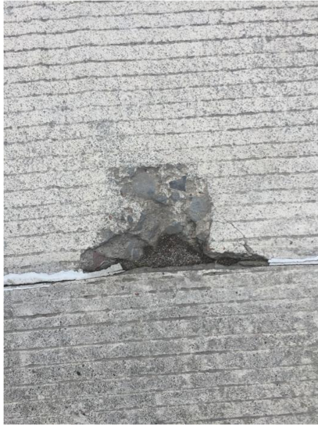
Figura 6-1014 Evidencia Fotográfica 5 PCI Armenia I
