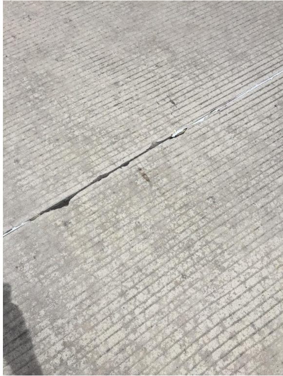
Figura 6-1012 Evidencia Fotográfica 3 PCI Armenia I
