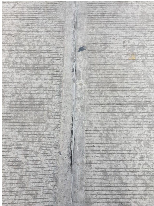
Figura 6-1009 Evidencia Fotográfica 1 PCI Armenia I
