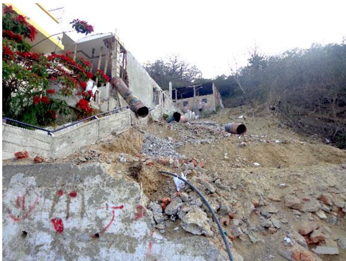
Figura 4: Afectaciones por deslizamiento de tierra - barrio La Cruz
