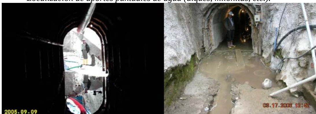
Figura No. 41 Condiciones Hidrogeológicas. (AIME & GEOCONSULT, 2006). 72
