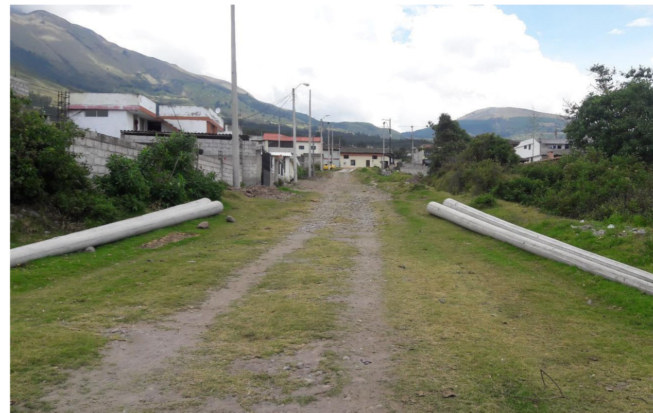
Figura 173: Estado actual de vía. Elaboración: (Matango & Mediavilla, 2020)
