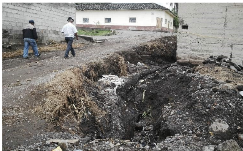
Figura 176: Sistema de alcantarillado del cantón Mira destruido por lluvias. Fuente: Diario La Hora.
