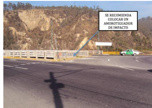
Fotografía 23. Se recomienda colocar un Amortiguador de Impacto. Vía a Zámbriza
