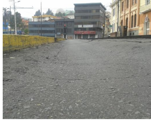
Fotografía 6. Imagen Transversal Ahuellamiento. Calle Tarqui
