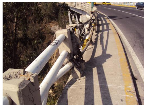
Fotografía 21. Barrera de Seguridad Impactada Vía a Zámiza
