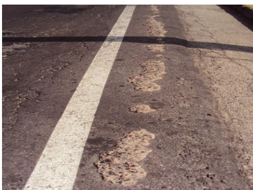
Fotografía 9. Asfalto regado en la vía Av. Interoceánica
