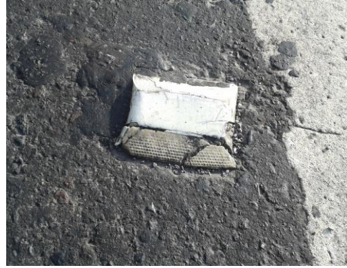
Fotografía 33. Tacha Color Blanco Mal Estado. Av. Simón Bolívar
