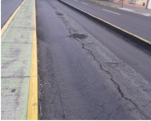
Fotografía 5. Ahuellamiento Producido Por BRT. Calle Tarqui
