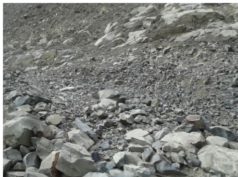
Fotografía 8. Rocas sueltas sobre la vía Vía Quito-Papallacta
