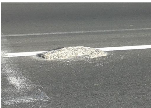
Fotografía 7. Residuo de Hormigón en vía de alto tráfico
