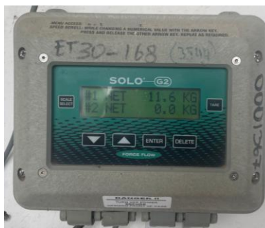
Figura 7. Sistema de pesaje y monitoreo para cilindros de cloro gas.
