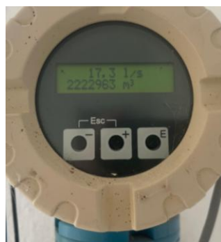
Figura 9. Registros de macromedición correspondiente a la salida del tanque de reserva.
