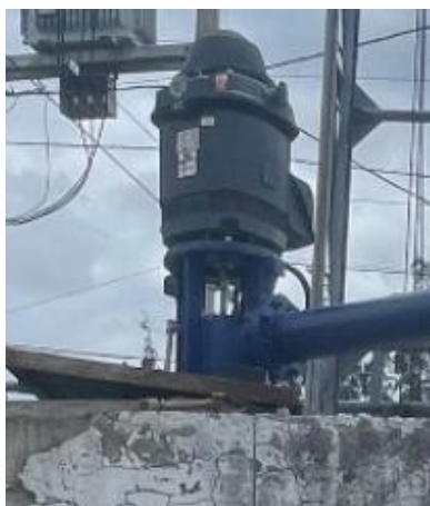
Figura 2. Motor del sistema de bombeo Techo Propio.
