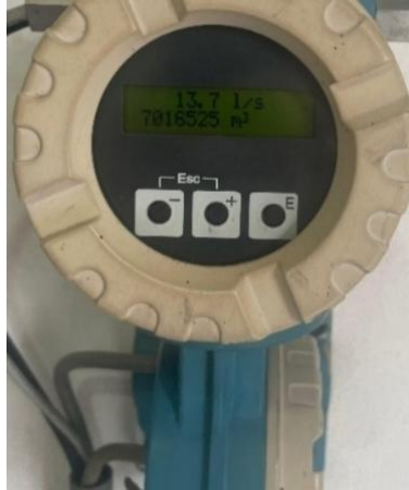
Figura 3. Registrador de caudal macromedición del pozo profundo.
