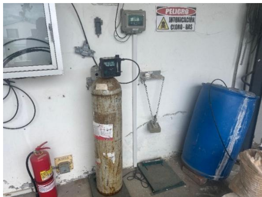
Figura 5. Conjunto de equipos que forman parte del sistema de cloración.
