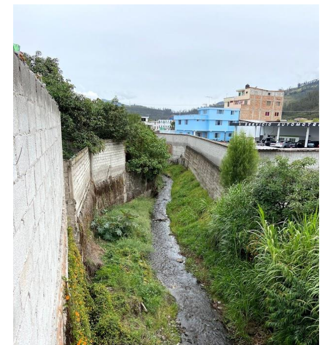
Figura 4 Quebrada San Clemente, Calle Curaray Fuente: Propia
