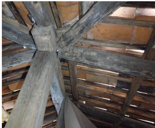
Figura 6. Evaluación visual de cubierta en madera con deterioro en puntos de unión estructural.
