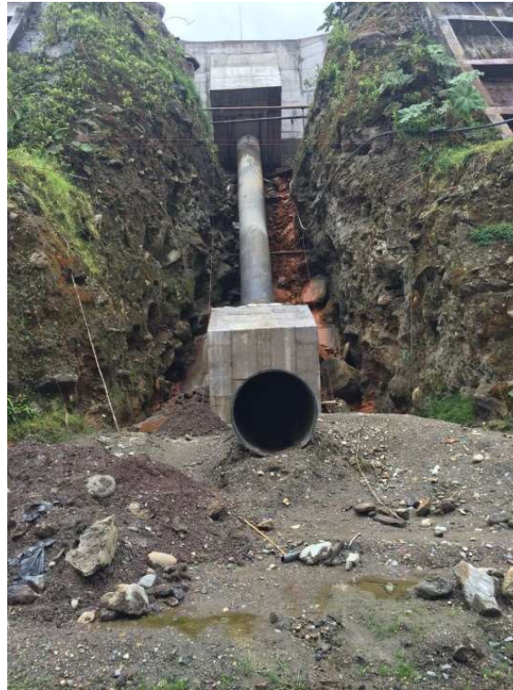
Fotografía 7.- Tubería de presión desde la casa de máquinas.
