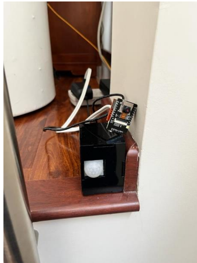
Figura 81: Dispositivos IoT - Sensor de movimiento y cámara
