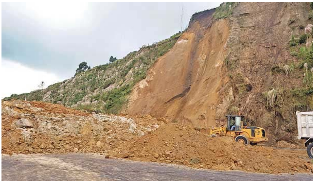
Figura 1.4 Deslizamiento del talud sobre la avenida Simón Bolívar – Sector la Forestal, 70 viviendas en peligro en mayo de 2011.
