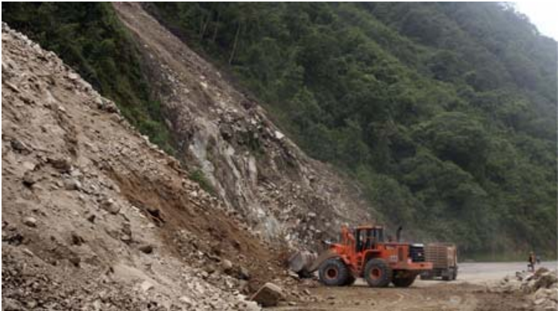
Figura 1.6 Deslizamiento en la carretera Alóag – Santo Domingo.
