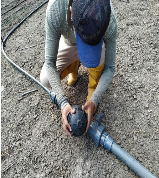
Anexo 47. Instalación del filtro para el sistema de riego por goteo.
