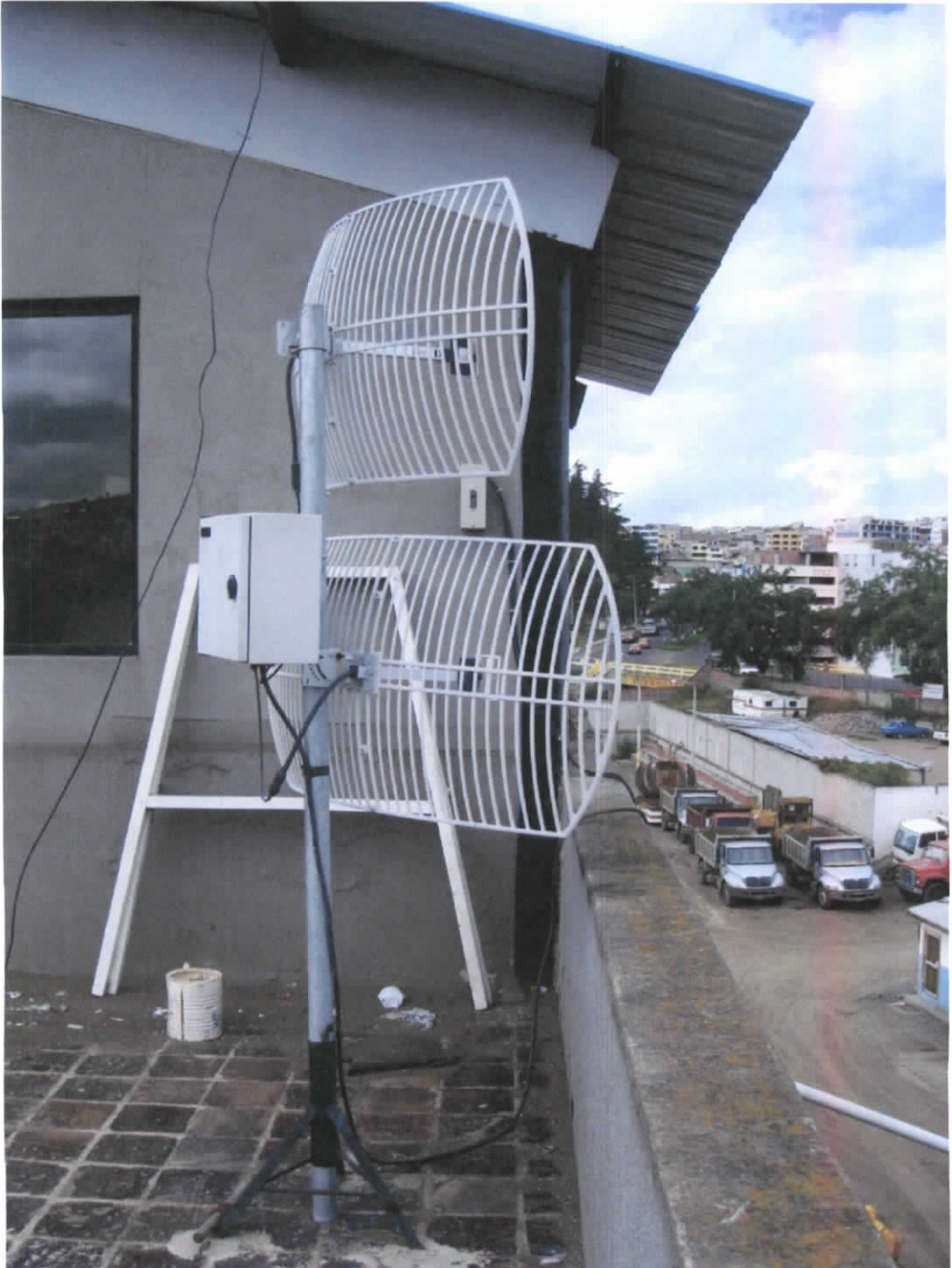
Figura 106: Antenas Spread Spectrum de Bodega y Talleres del HCPT
