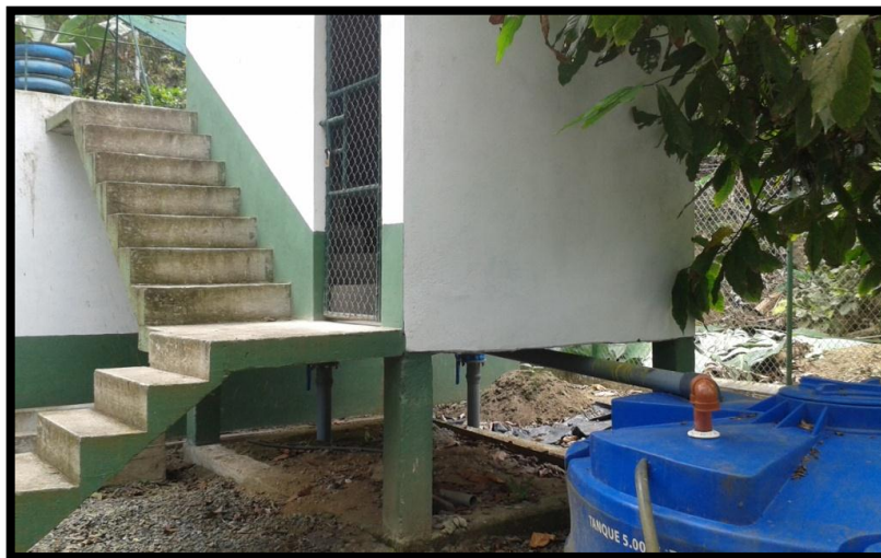
Foto 6. Cuarto de cloración.
