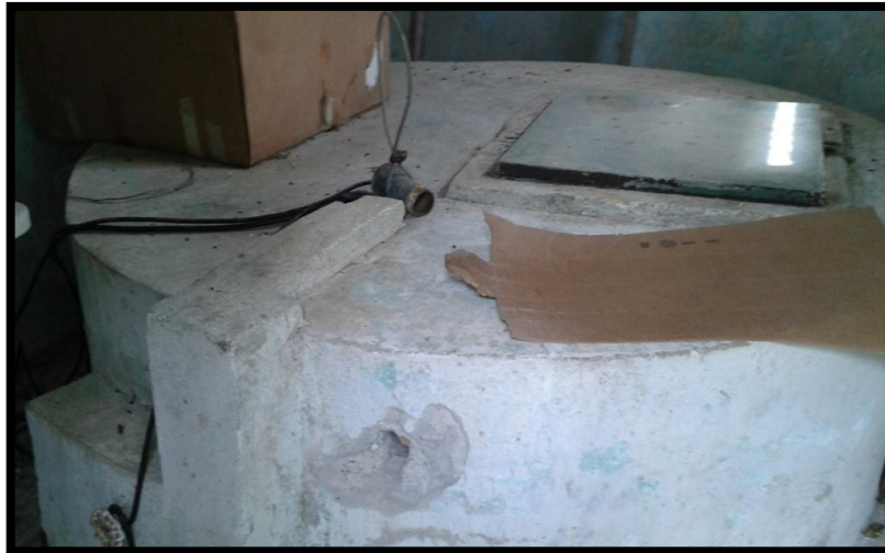
Foto3. Pozo para el almacenamiento de agua.
