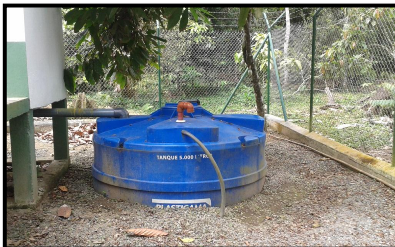
Foto7. Reservorio de agua.
