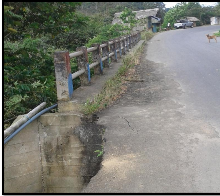
Foto 12. Estado de los extremos de los puentes
