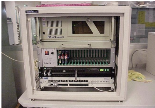
Figura 1.23: Central de Zona Fuente: TYCO TRAFICC
