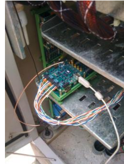
Figura 3.39, Módulo de sensor instalado en Guayaquil Fuente: ITERIS Elaboración: Propia
