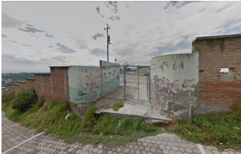
Ilustración 17 Mal estado de los equipamientos (Google Earth, 2017).
