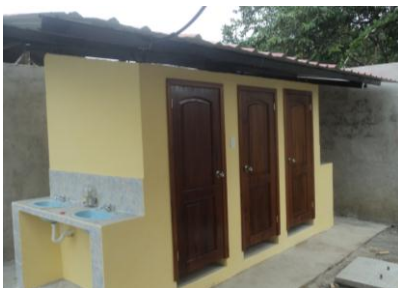
Figura 9. Baterías sanitarias del GADPR Sevilla
