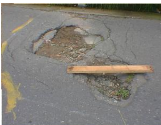
Fotografía 3: Baches en la Superficie de Rodamiento
