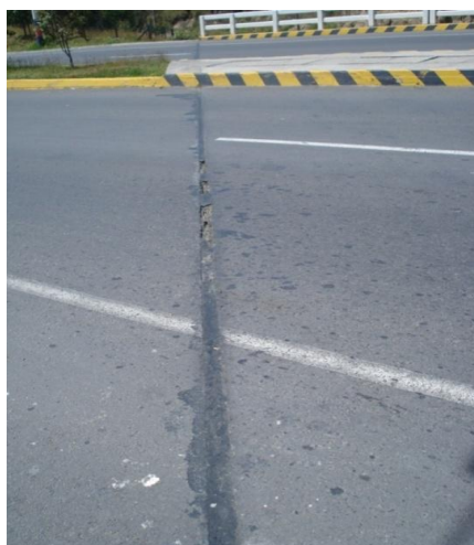
Desprendimiento del recubrimiento de la junta
