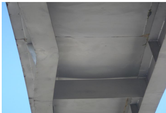
Falla producida por impacto
