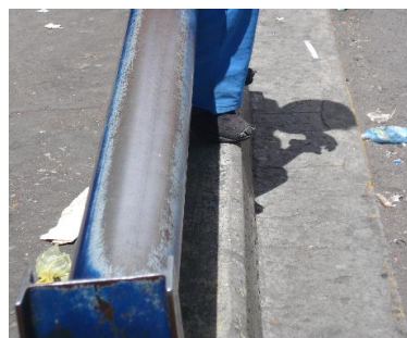
Delaminación de la pintura en barandas
