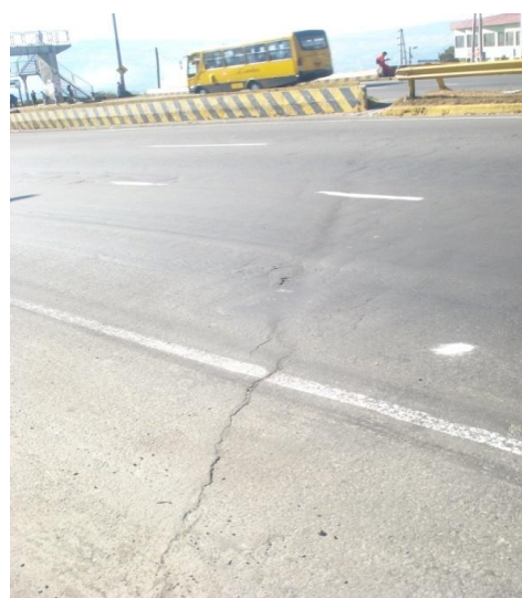
Fisura por reflexión de junta
