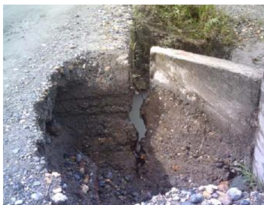
Fotografía 15: Fisura por Volcamiento
