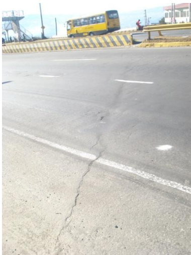
Fotografía 14: Fisura por Reflexión de Junta en la Superficie de Rodamiento
