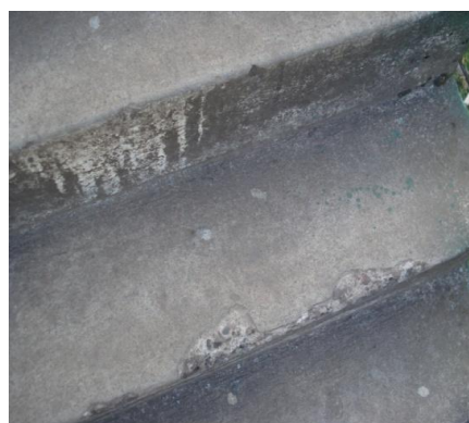
Desprendimiento de hormigón
