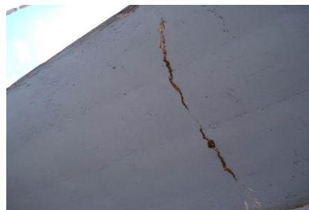
Fisura por flexión y presencia de hormigueros
