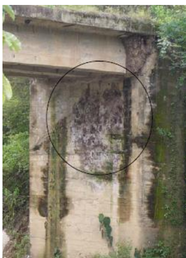
Fotografía 18: Presencia de Eflorescencia en Estribos
