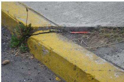
Fisura por reflexión de junta
