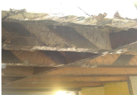
Fisuras por cortante en vigas
