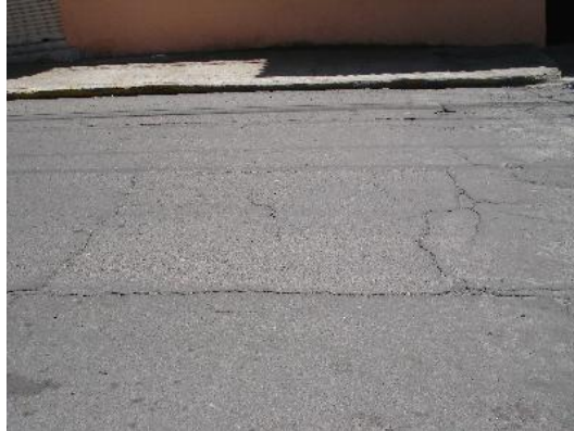
Fotografía 12: Fisuras en Bloque en la Superficie de Rodamiento
