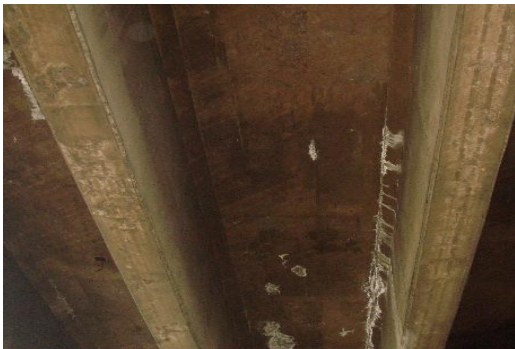
Presencia de hormigeros y eflorescencia en vigas
