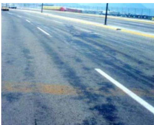
Fotografía 2: Presencia de Exudación en la Superficie de Rodamiento
