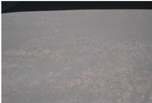
Peladura en la superficie de rodamiento
