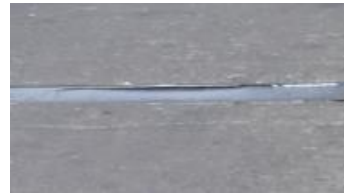
Fracturamiento en la junta
