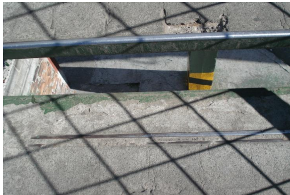
Desprendimiento de hormigón
