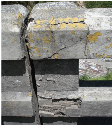
Delaminación de la pintura, fracturamiento y presencia de fisuras en barandas
