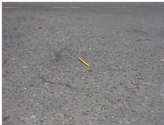
Fotografía 1: Presencia de Peladura en la Superficie de Rodamiento
