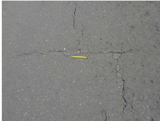
Fotografía 10: Fisuras Transversales en la Superficie de Rodamiento
