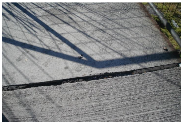
Desprendimiento de sello elastomérico
