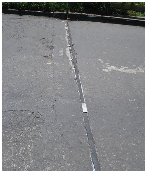
Exposición del acero de refuerzo en el guardacantos
