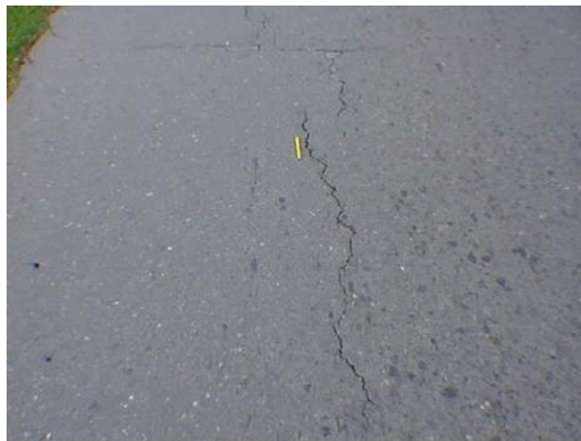
Fotografía 9: Fisura Longitudinal en la Superficie de Rodamiento
