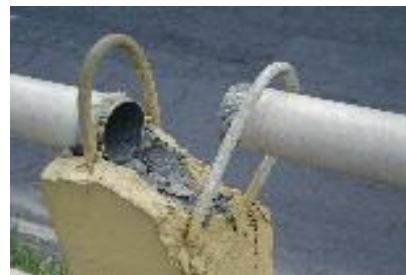
Fracturamiento en barandas
