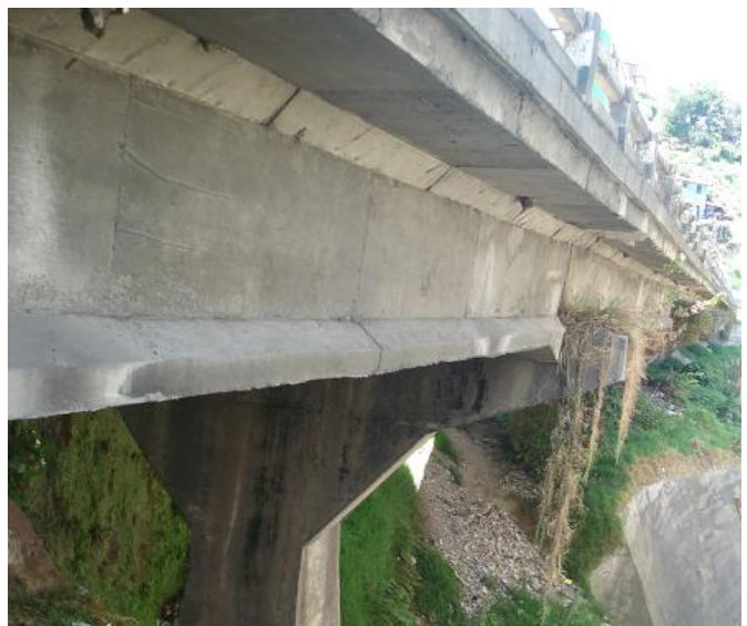
Presencia de hormigueros y eflorescencia en losa y vigas
