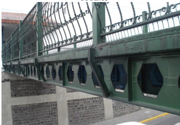
Corrosión Leve, pintura deteriorada
