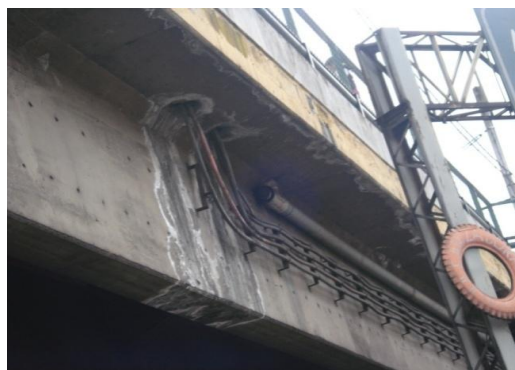
Presencia de hormigeros y eflorescencia en la losa
