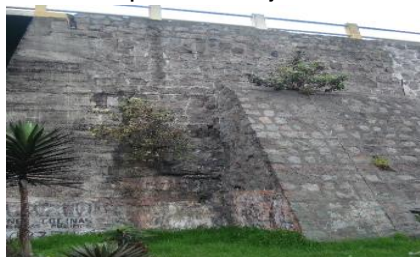
Eflorescencia en muros de contención
