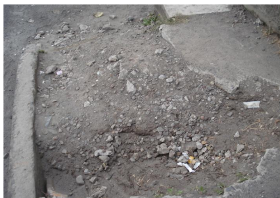
Desprendimiento de hormigón en la acera
