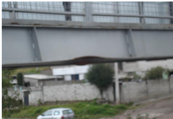
Falla producida por impacto
