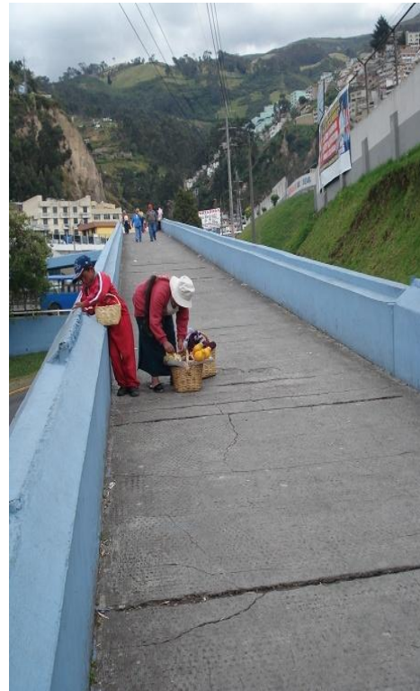
Fisuras longitudinales y transversales
