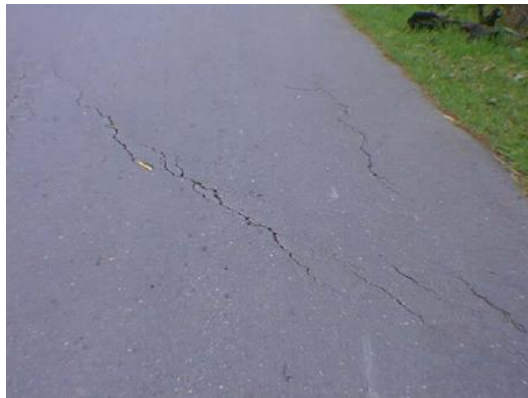
Fotografía 11: Fisuras de Borde en la Superficie de Rodamiento
