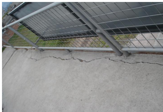
Fisura de borde
