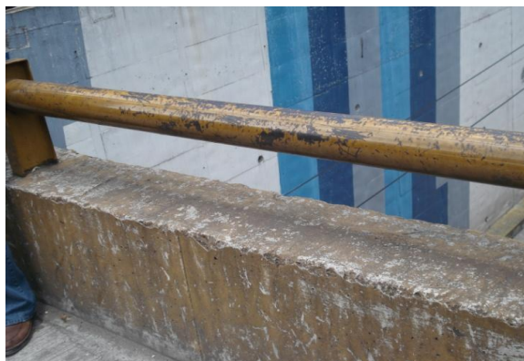
Delaminación de la pintura en barandas
