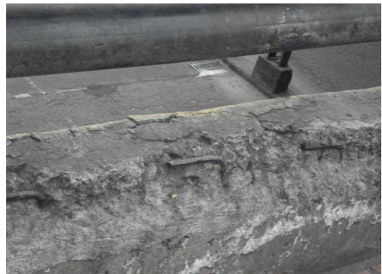
Delaminación de la pintura y fracturamiento en barandas
