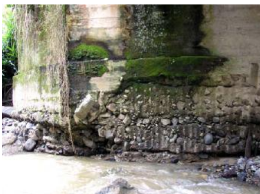
Fotografía 20: Estructura Afectada por Socavación
