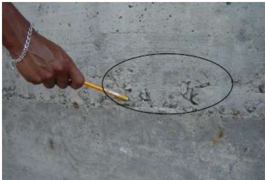
Fotografía 17: Segregación en el Hormigón
