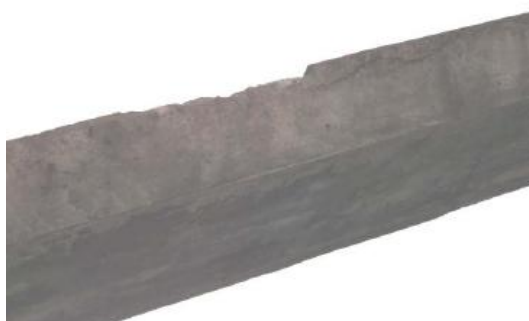
Fotografía 24: Pérdida de Recubrimiento de los Cables
