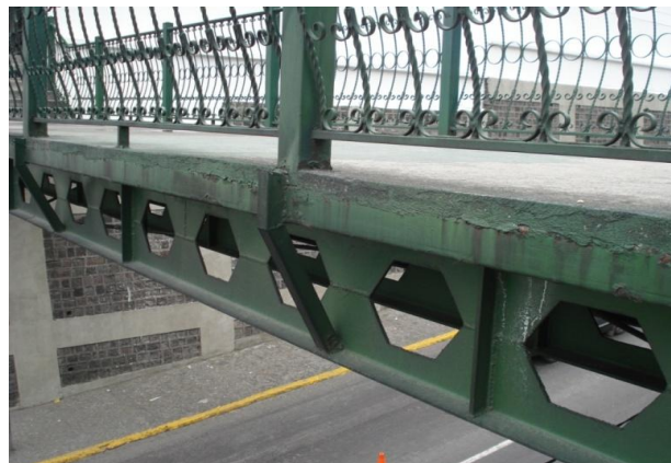
Corrosión Leve, pintura deteriorada
