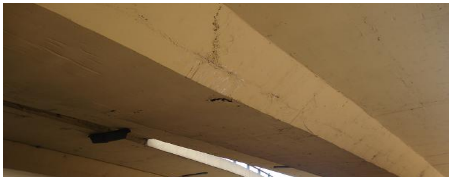
Hormigueros, segregación y eflorescencia en la losa
