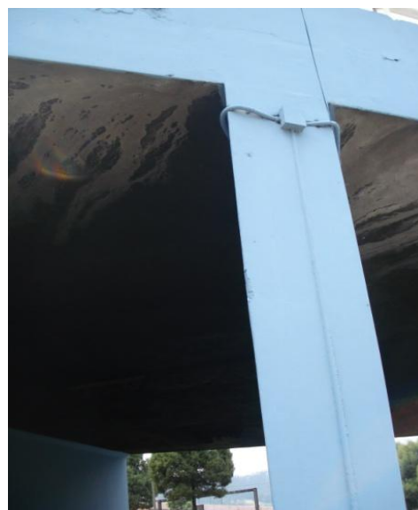
Presencia de smog en la losa
