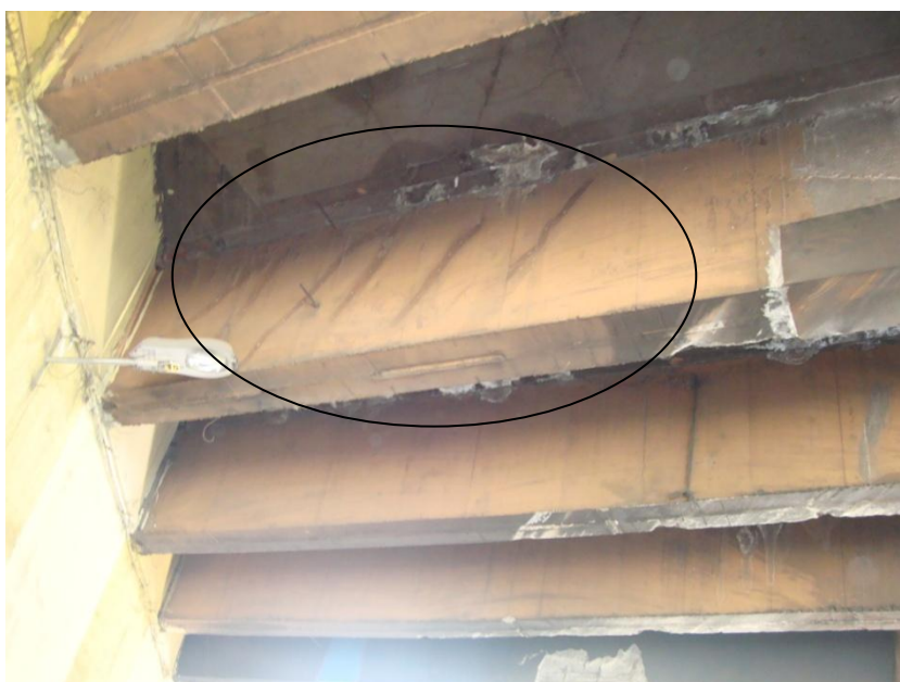
Fotografía 34: Fisuras por Corte presentes en las cercanías de los apoyos de la viga Tomada el 13 de noviembre del 2009
