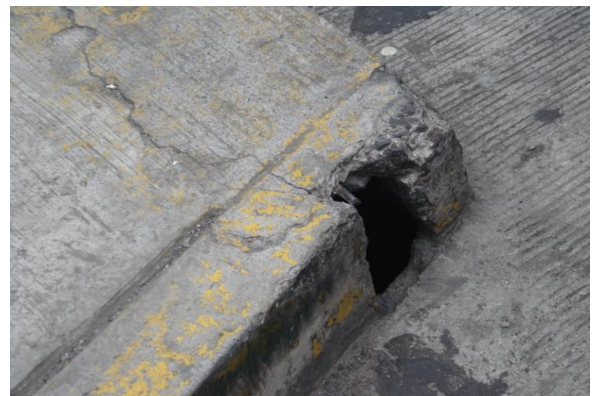
Desprendimiento de hormigón en la acera
