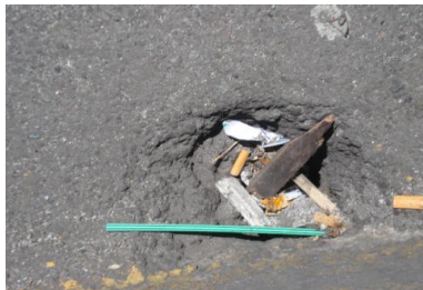
Taponamiento en el drenaje
