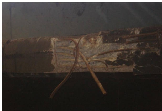
Corrosión de la armadura y fallas por impacto en las vigas
