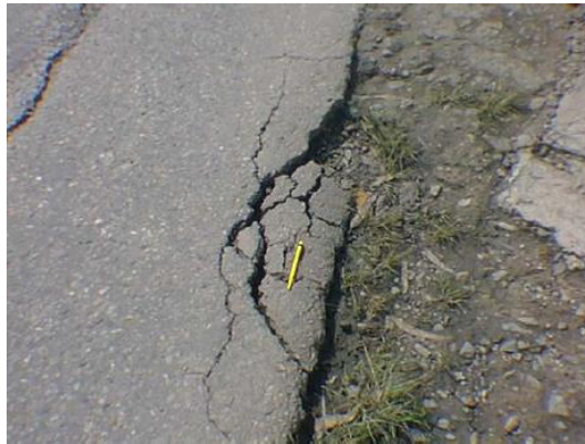
Fotografía 4: Desintegración de Bordes en la Superficie de Rodamiento
