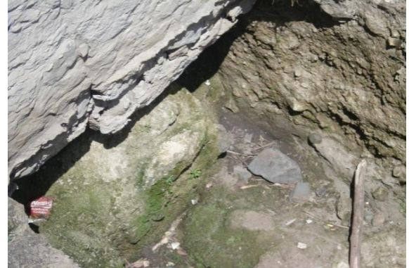
Socavación en los muros de contención
