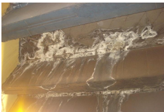
Eflorescencia en losa y vigas
