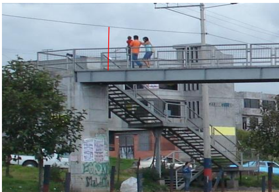
Altura ineficiente del tendido eléctrico
