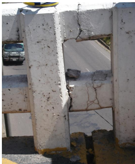
Fisuras en barandas
