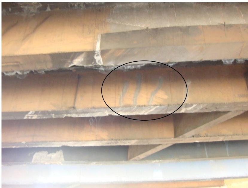
Fotografía 33: Fisuras por Flexión presentes en las cercanías de la semiluz de la viga Tomada el 13 de noviembre del 2009
