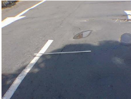
Fotografía 8: Hundimiento de la Superficie de Rodamiento
