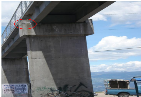
Falla de corte
