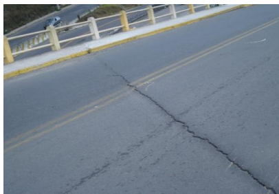
Fisura por reflexión de junta
