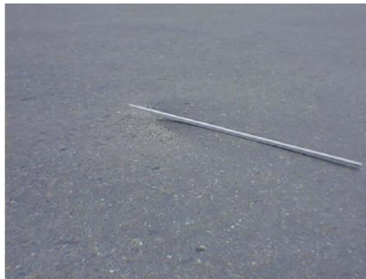
Fotografía 7: Presencia de Abultamiento en la Superficie de Rodamiento Extraída de: http://www.ufpso.edu.co/ftp/pdf/documentos/charla_fallas_pavimentos_flexibles.pdf
