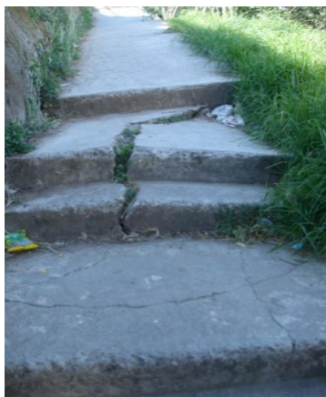
Fracturamiento en gradas de acceso
