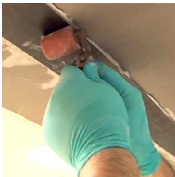
Figura 3.2.4. Presión en sistema FRP (Fibras de carbono) instalado 45
