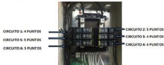
Figura 10. Tablero de breaker para circuitos
