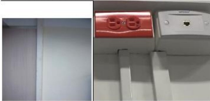
Figura 2. Ubicación de Canaletas
