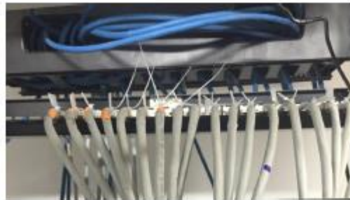
Figura 8. Organización del cable 6A con etiquetas
