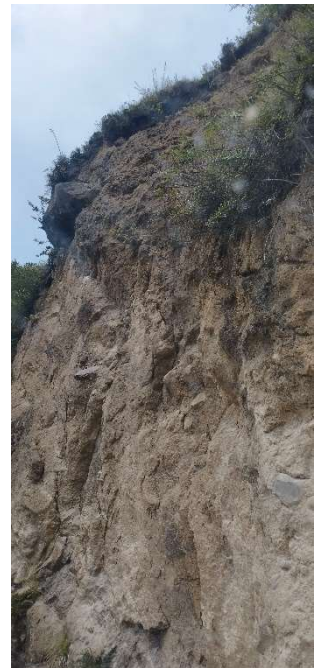
Talud sin reforzamiento alguno
