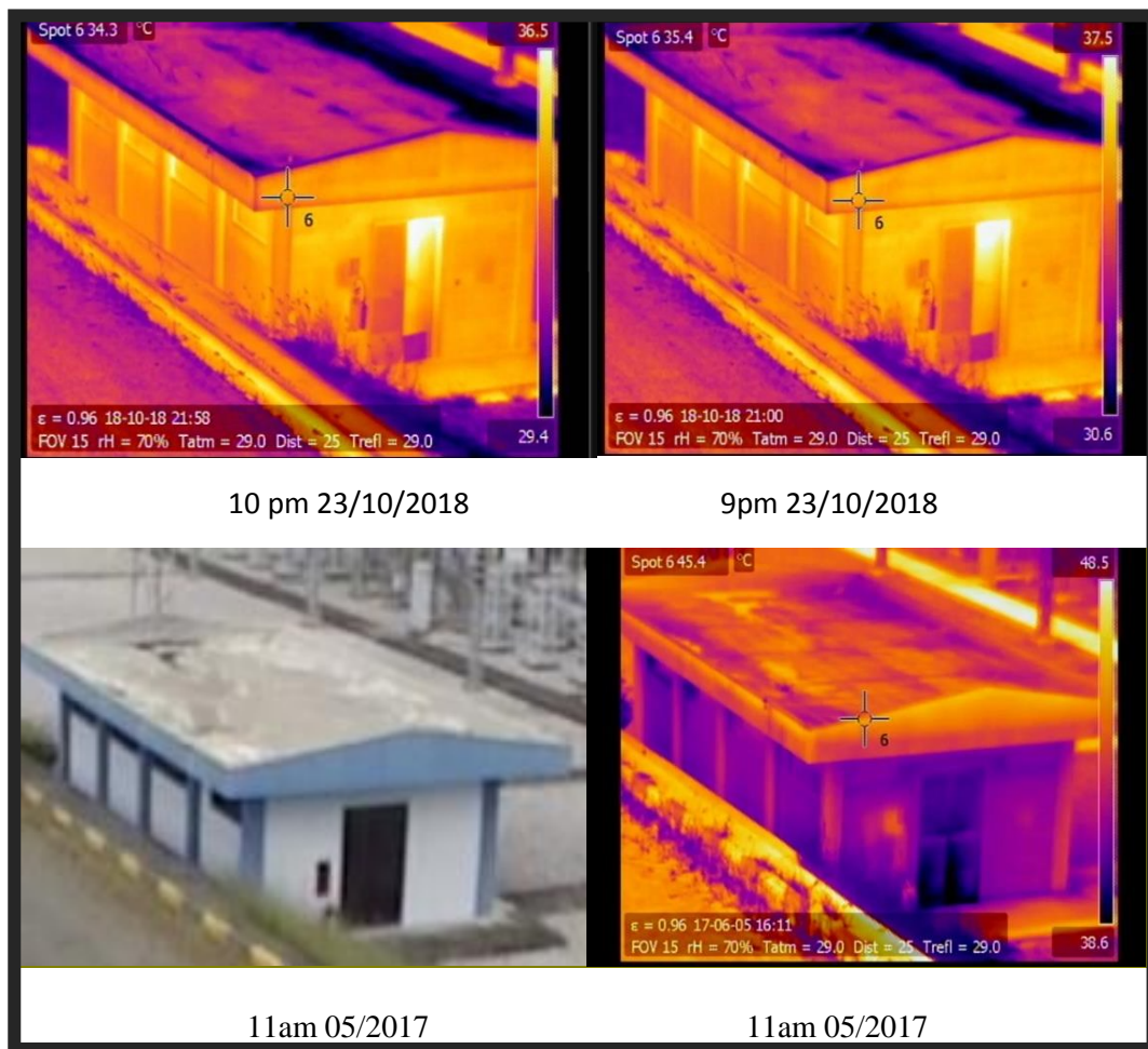
ILUSTRACIÓN 7 CÁMARA FIJA SUBESTACIÓN PASCUALES CASA DE TABLEROS (GUAYAQUIL)
