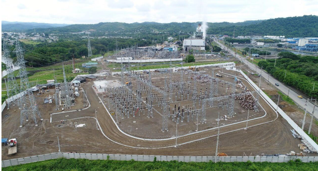
ILUSTRACIÓN 6 FOTO AÉREA SUBESTACIÓN ESMERALDAS
