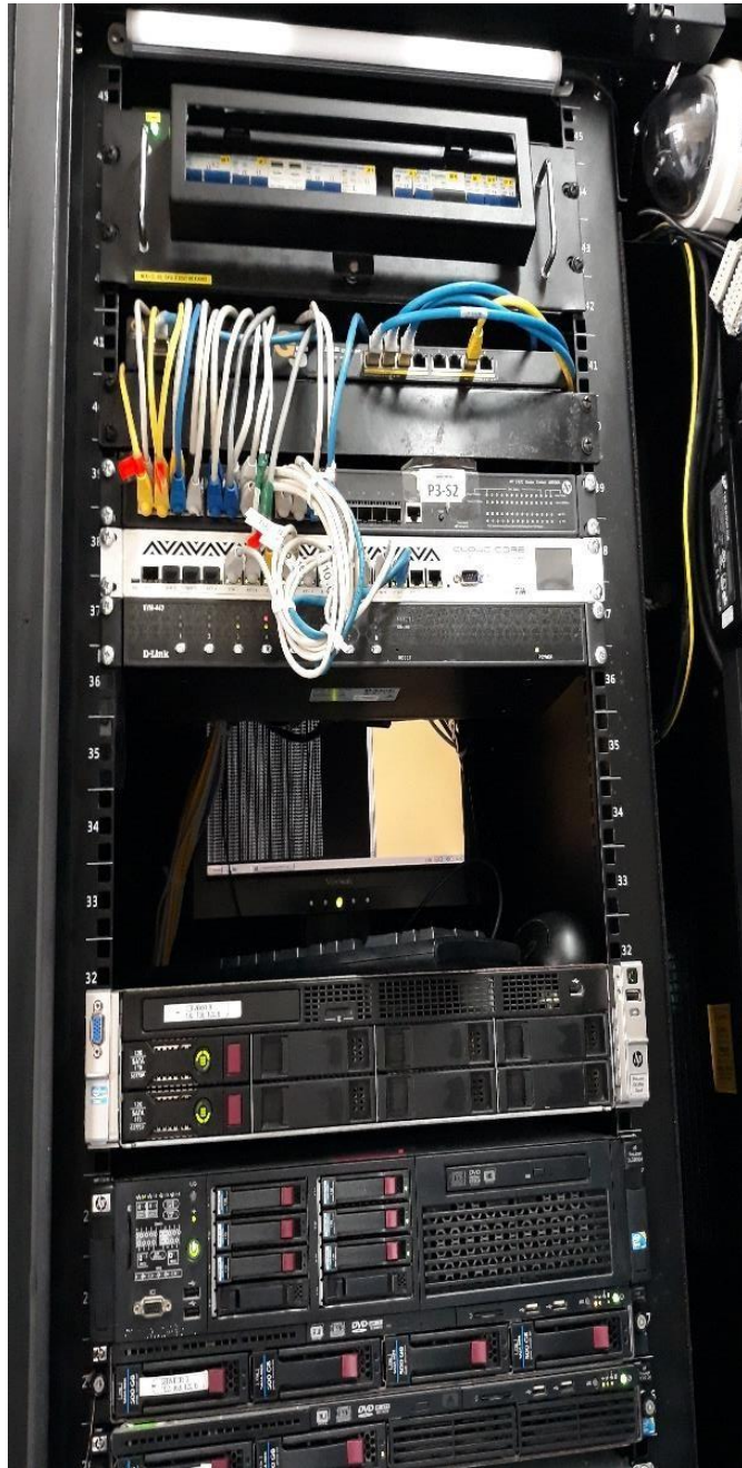
ANEXO 12 INTERIOR DEL DATA CENTER
