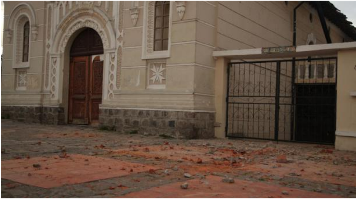
Fotografía No1: Iglesia de Calderón afectada por sismo de Agosto 2014 Fuente: El Comercio, 2014
