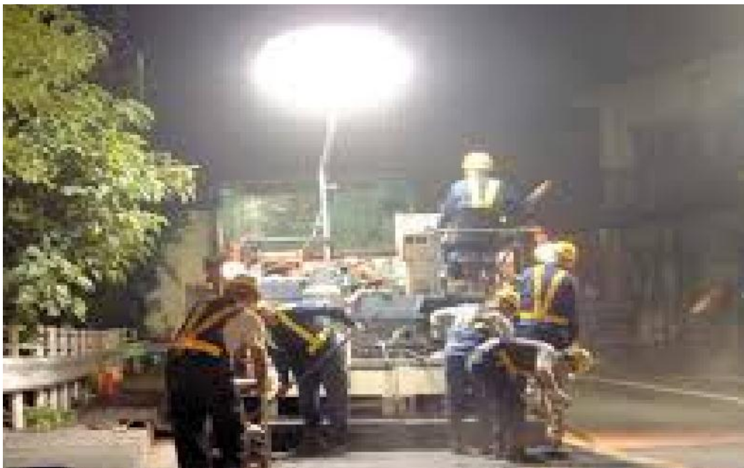
Ilustración 2.22: Iluminación de Obra
