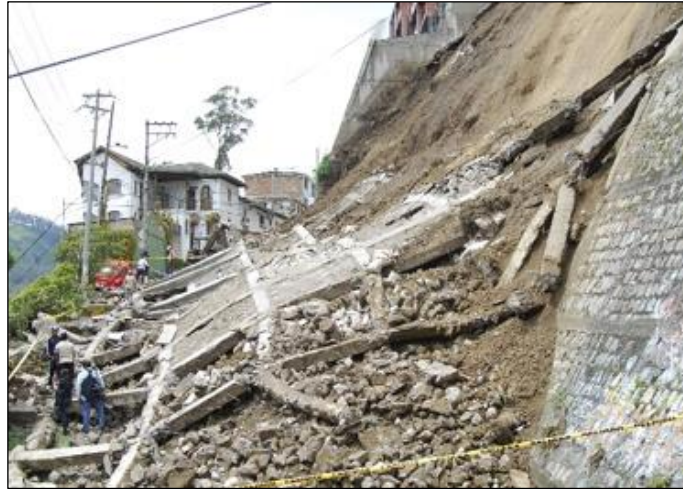
Figura 1.9 Falla de muro - https://.licuefaccion+de+suelos.b44oHABg&sqi=2&ved .
