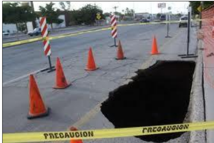
Figura 1.10 Falla de alcantarilla por asentamiento diferencial - https://ASENTAMIENTO+de+suelos.isch&sa=X
