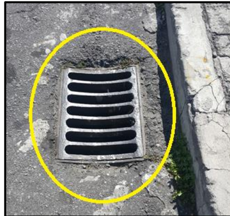
Imagen 23: Sumidero de tipo calzada.
