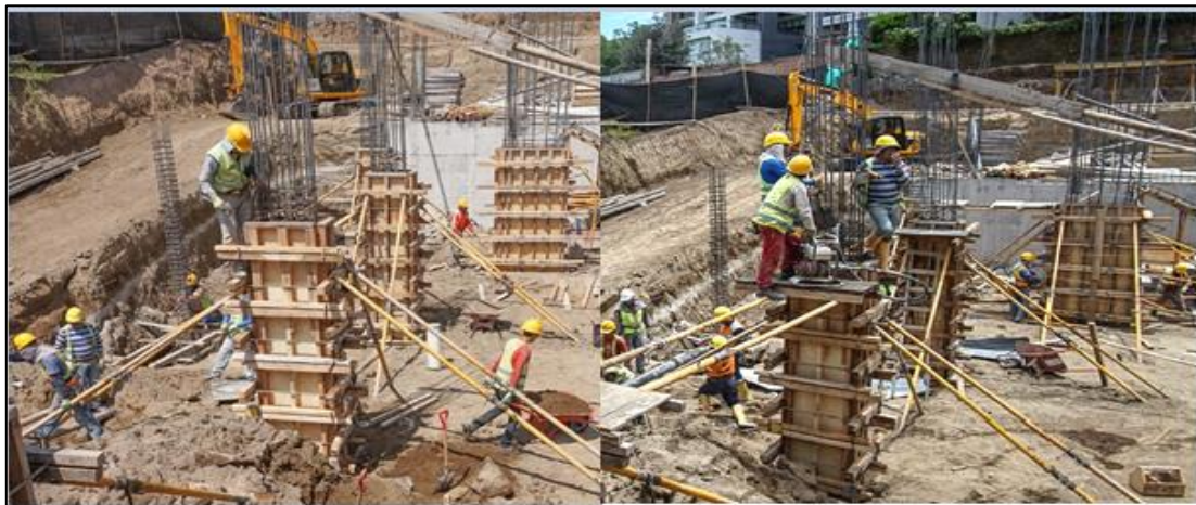
Figura 94. Falta de equipo de seguridad trabajos en altura
