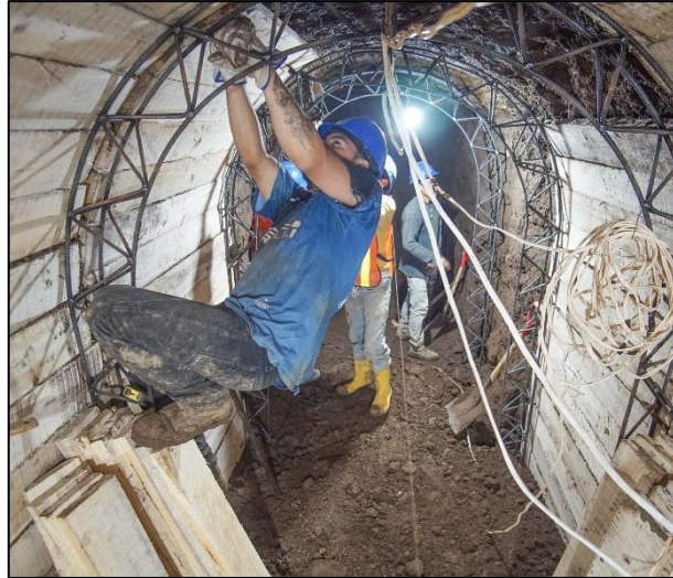
Figura 96. Falta de uso de equipo de seguridad, y mala práctica de seguridad laboral Elaborado por: El autor
