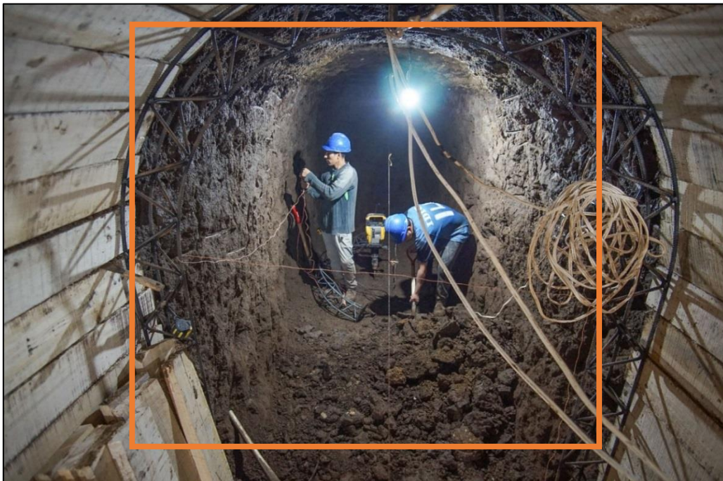
Figura 77. Inicio trabajos entibado y encofrado permanente de túnel Elaborado por: El autor
