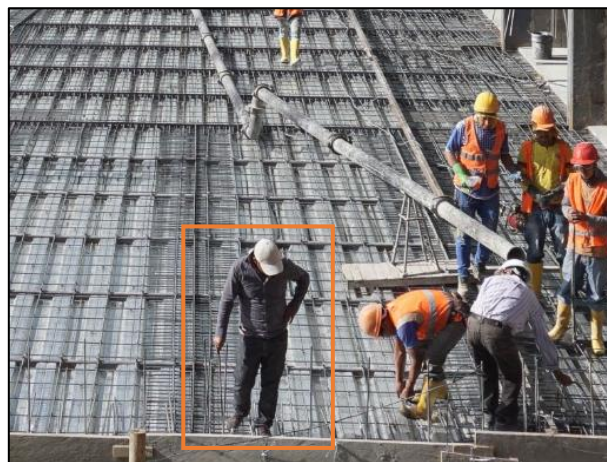
Figura 95. Contratista sin equipo básico de seguridad
