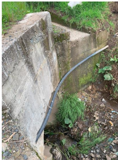
Ilustración 27. Fotografía con acumulación de lodos dentro de la alcantarilla
