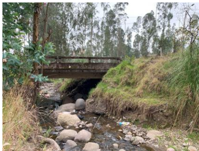
Ilustración 19. Fotografía de cuneta con acumulación de lodo y basura
