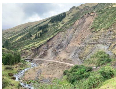
Ilustración 24. Fotografía con deslizamiento de talud
