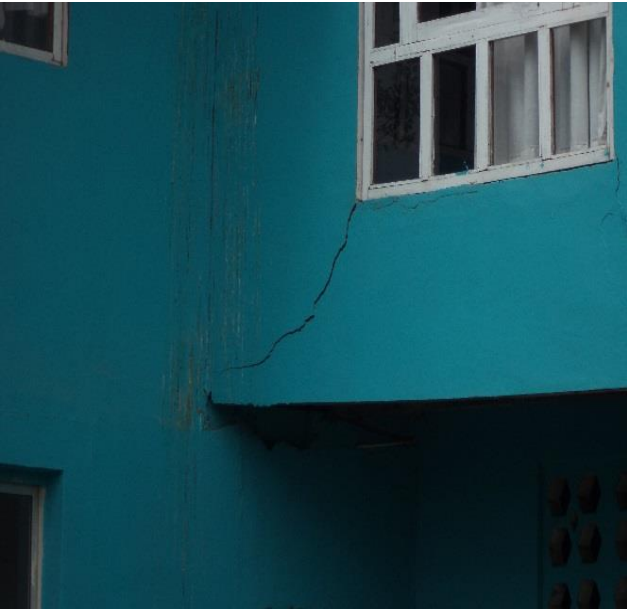
Fisura en vivienda
