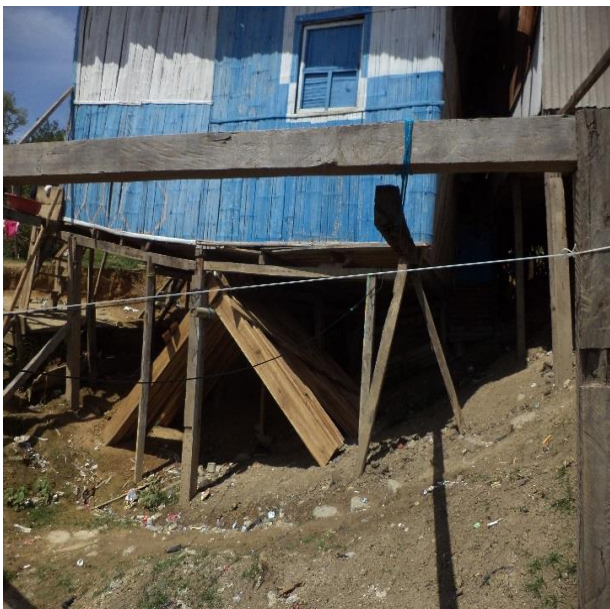
Desnivel de vivienda
