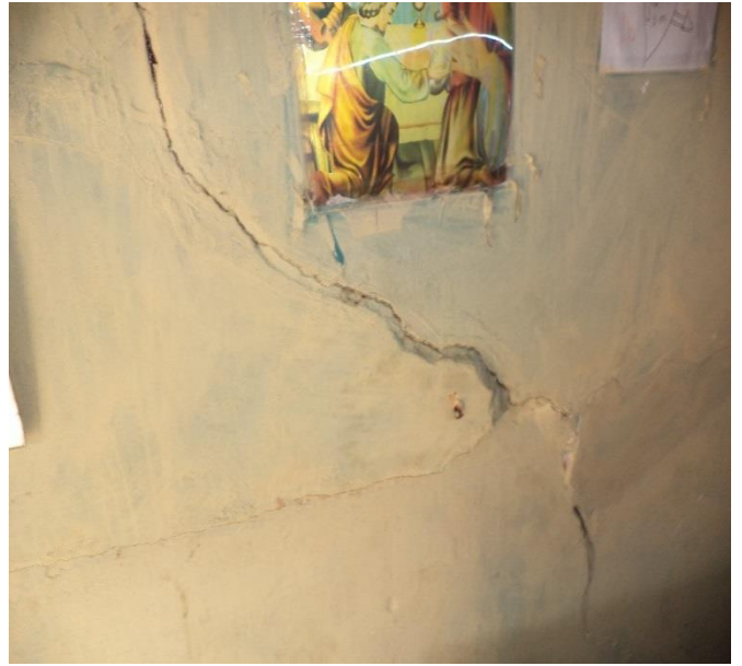
Fisura de Viviendas
