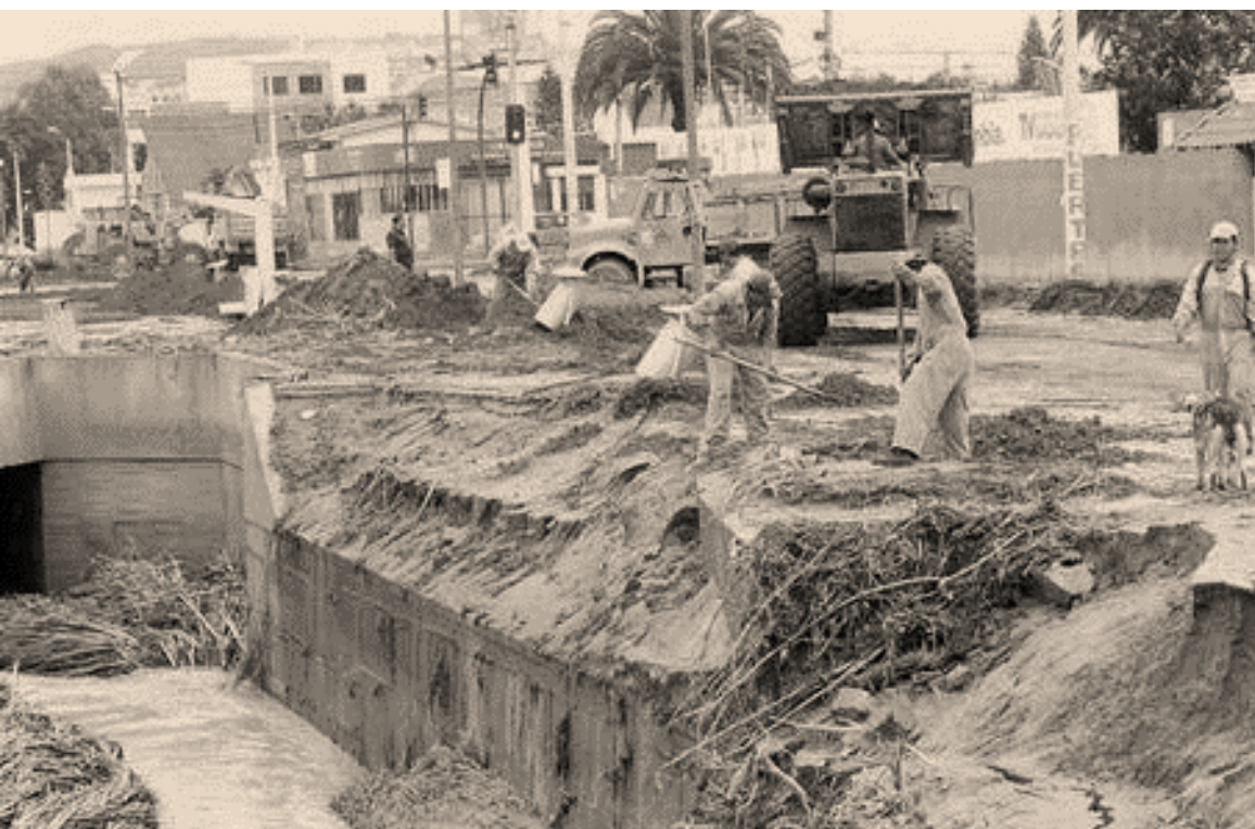
Ilustración 3: Trabajadores municipales limpiaban los escombros que dejó la inundación por el desbordamiento del río Ajaví (2011) / Fuente: Diario "El Universo"
