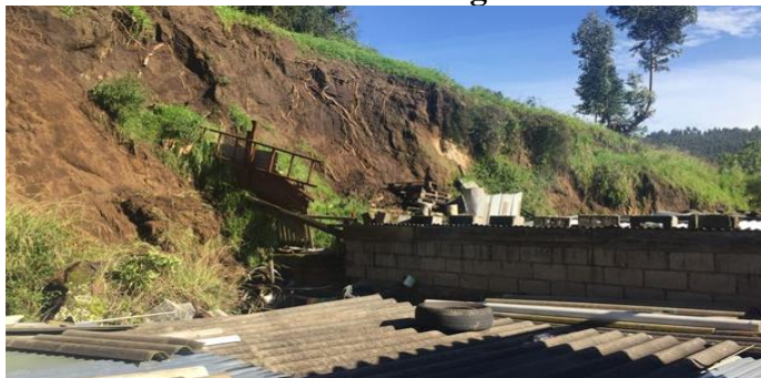
Fotografía 9. Inestabilidad de Talud cerca de vivienda en Amaguaña
