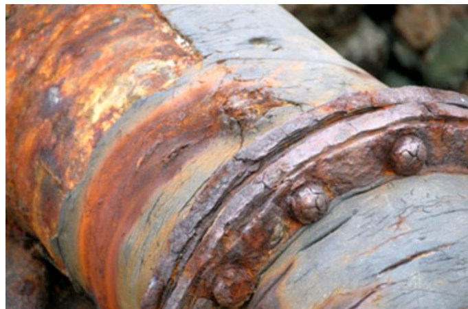
Figura 6.- Corrosión en una tubería de agua potable
